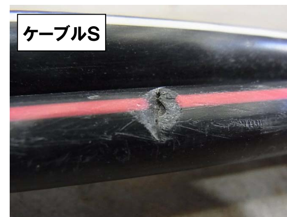
シースを貫通した傷
