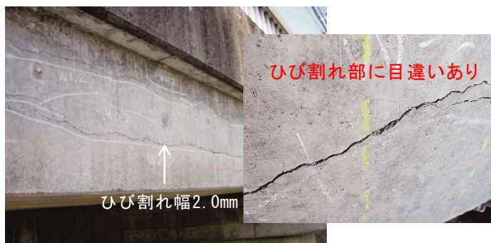
写真-1 PC桁側面のひび割れ状況
