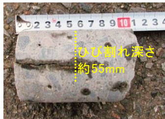
写真-5 コアによるひび割れ深さ
