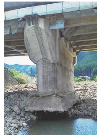
写真-2 洗掘状況
