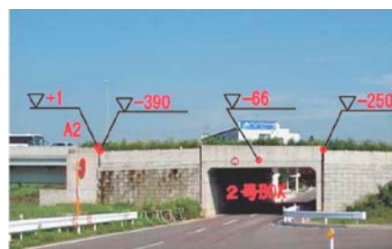
写真-3 A2側橋台背面の沈下
