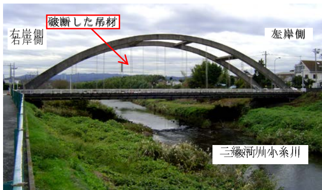
写真-1 橋の外観と吊材の破断位置
