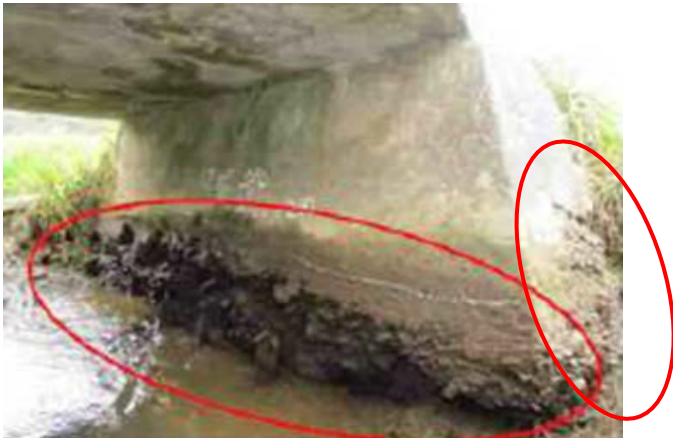
橋台前面にも洗掘が見られる
