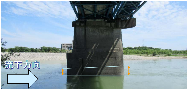
打ち継ぎ目が喫水線と平行になっていない。
