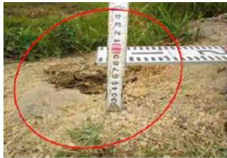
橋台背面部に陥没
