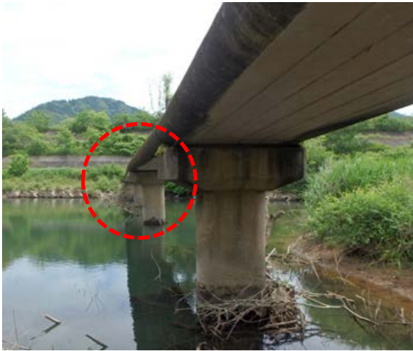
橋脚躯体の傾斜が見られる。
