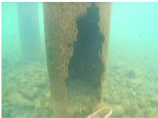
パイルベント橋脚の腐食
