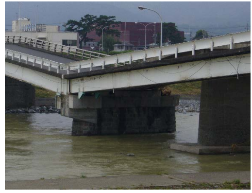
橋脚(ケーソン基礎)の沈下・傾斜
