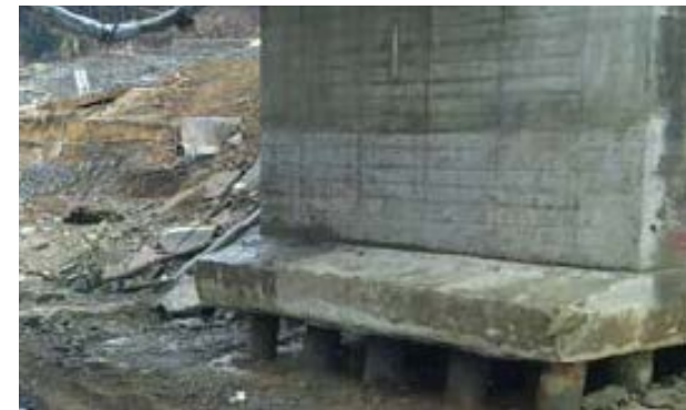
津波後に発見された損傷
