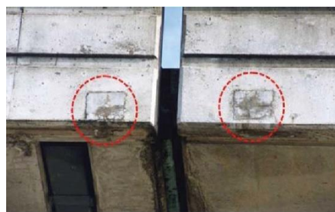
写真 2.4 ひび割れ、漏水（定着部）
