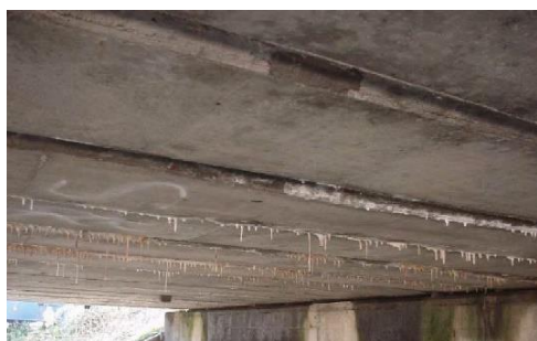
写真 2.3 遊離石灰（間詰め部）
