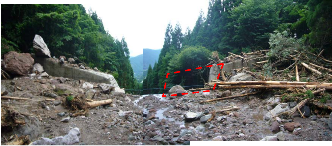
写真4 1号砂防えん堤の被災状況（赤い波線は袖部が飛んだ箇所）。土石流は袖部を越流している。
