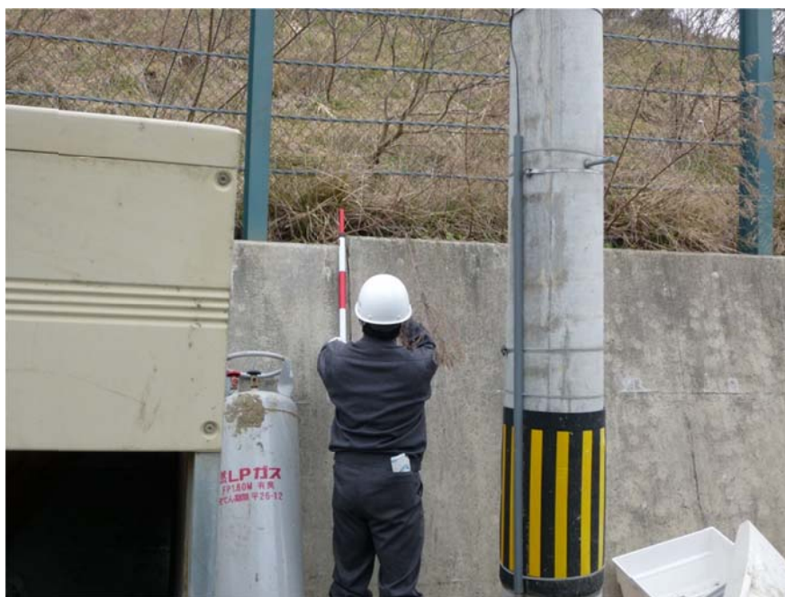
擁壁工に施工目地を挟んで、地震の影響と見られる 3 cm 程度の縦ズレが発生している箇所があった。
