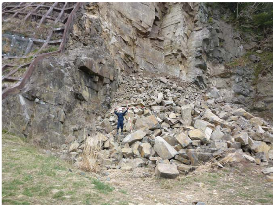
治山事業による法枠の右斜面での崩落 斜面下の人家の住人によると 4 月 7 日の地震でも崩落があったとのこと。
