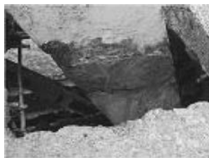
鋼トラス部材の埋め込み部の破断
