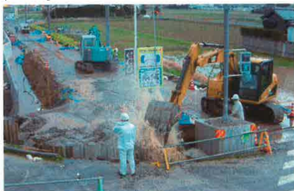
写真-1 水道管損傷事故
