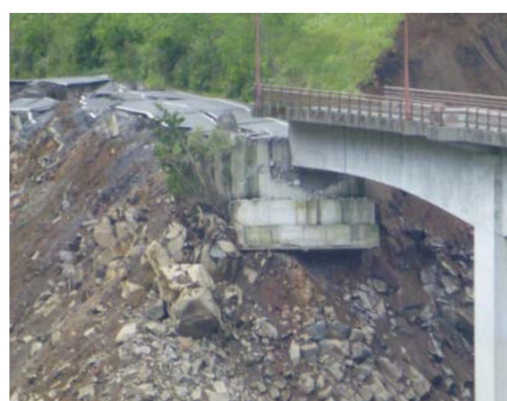
斜面崩落による 橋台の沈下
