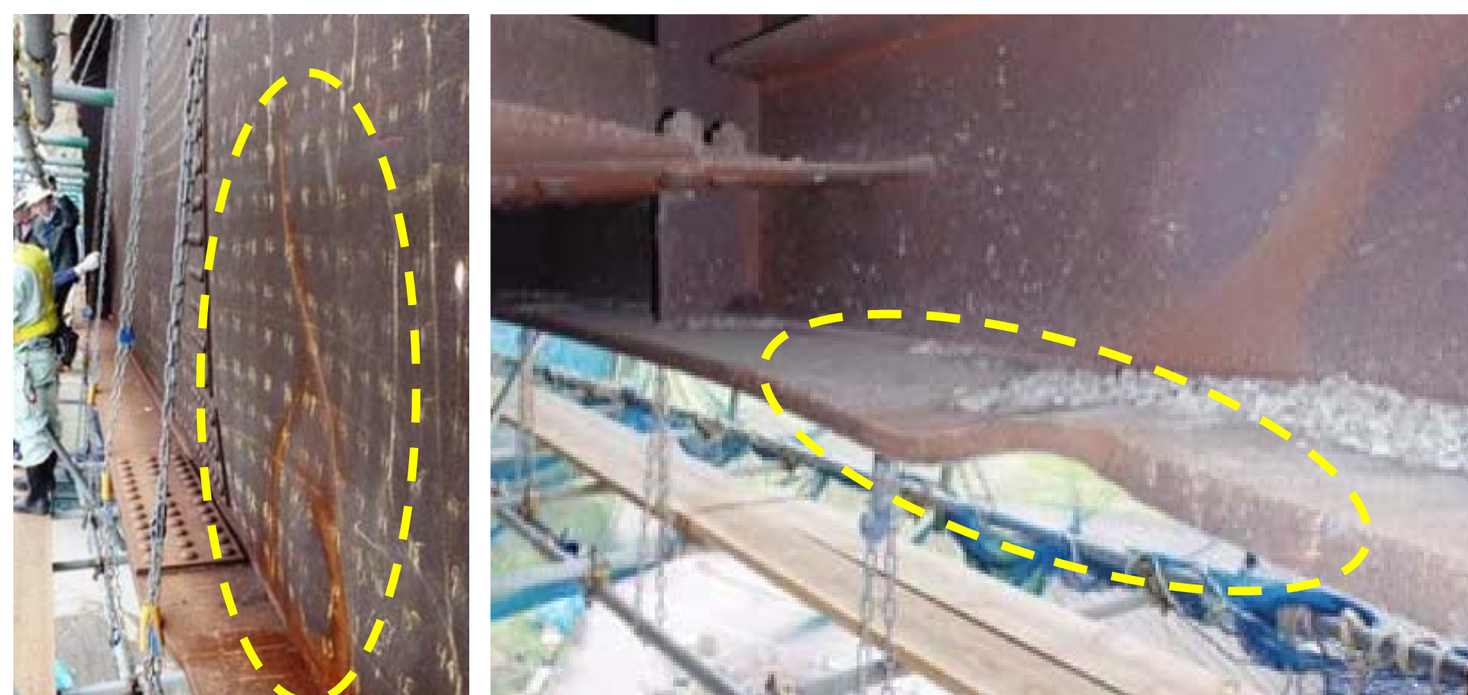
桁に生じた変形
