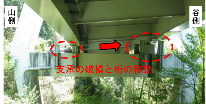
⑤P1支承部の破損
