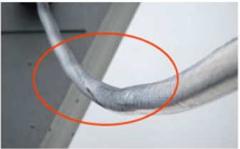
④ケーブルのよれ
