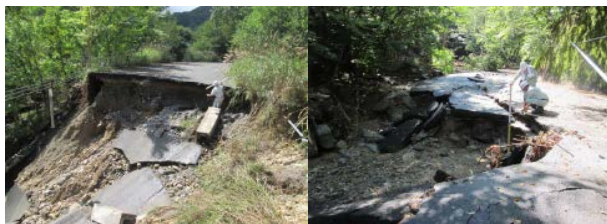
写真-2 関東・東北豪雨で壊滅的被害を受けた道路
