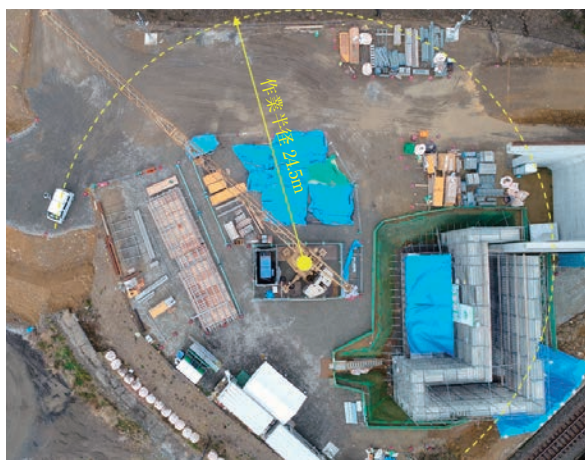
写真-2 定置式水平ジブクレーンの作業範囲
