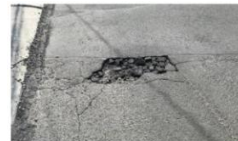
②道路損傷個所を撮影
