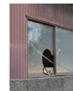
窓が割れた管理不全空家
