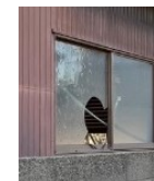
窓が割れた 管理不全空家
