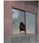
窓が割れた 管理不全空家
