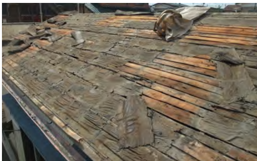
写真 3.2.5 アスファルトフェルトの波打
