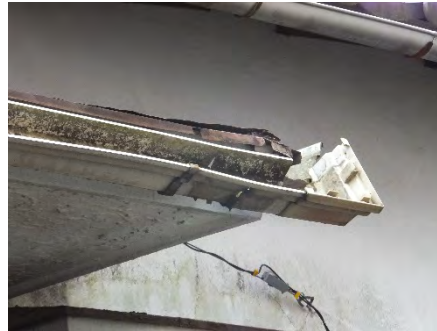
写真 3.6.2 雪で曲がった軒樋
