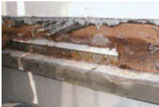
写真 3.2.9 金属水切りの腐食
