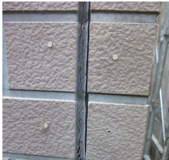
写真 3.4.3 サイディングのシーリング切れ・剥離
