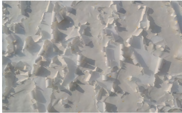
写真 3.2.7 透湿防水シートの紫外線による劣化
