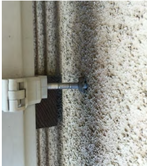
写真 3.5.3 たて樋の取付け金物の取付け勾配が外部から内部へ
