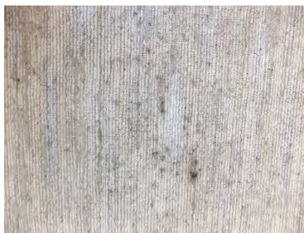
写真 3.6.3 家具背面外壁ビニールクロス面のカビ跡（黒いしみ）
