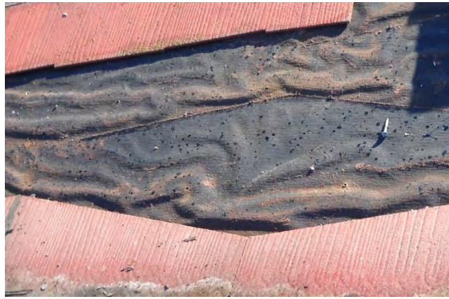
写真 3.4.23 下葺き材の波打ちによる水みち
