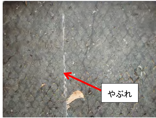
写真 3.2.4 耐久性不足によるアスファルトフェルト 8kg のやぶれ
