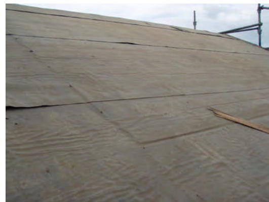
写真 3.2.6 アスファルトフェルトの劣化
