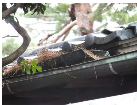
写真 3.6.1 軒樋に溜まった枯葉
