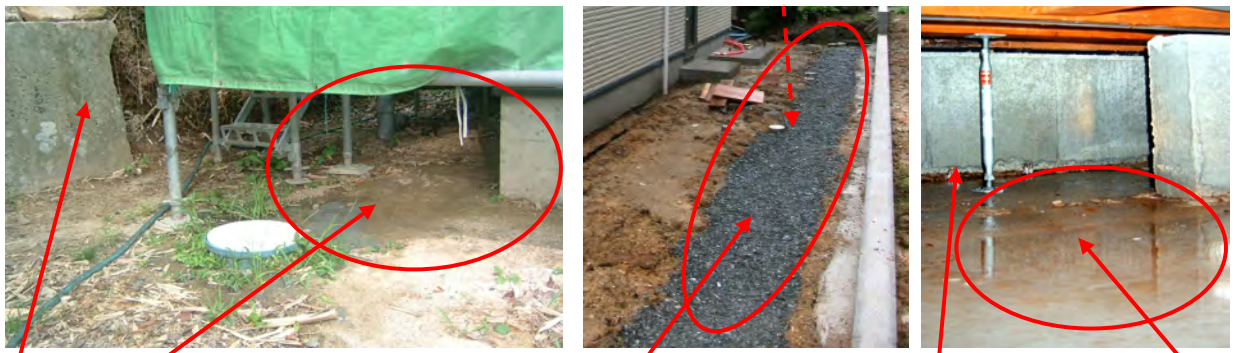
上段の土留 湧水による宅地の湿潤状態
