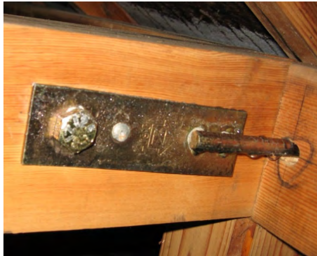
写真 3.4.20 小屋組構造金物の結露
