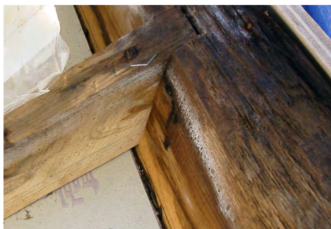
写真 3.4.18 垂木を棟木へ落とし込み通気阻害
