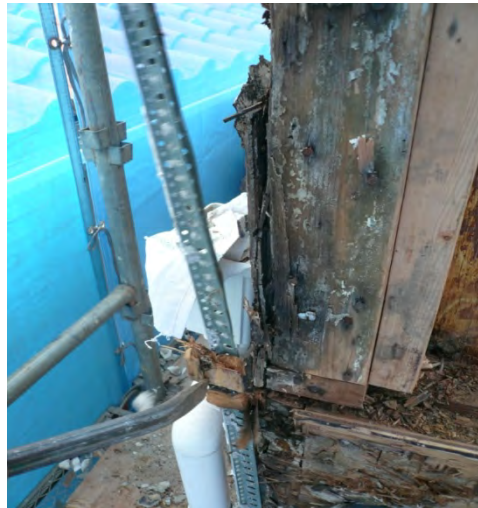
写真 1.4.2 木造住宅外壁内部劣化事例
