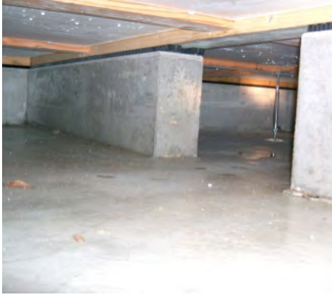
写真 3.2.2 過剰水分による床下の結露
