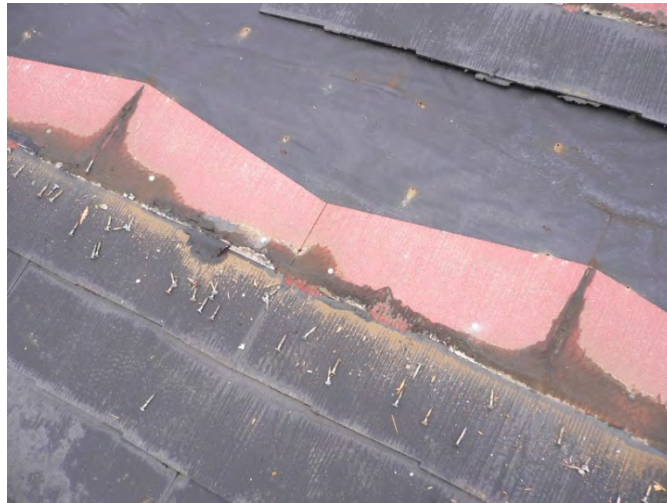
写真 3.4.26 化粧スレートの縁切り不足
