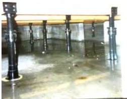
基礎打継からの浸水事例
