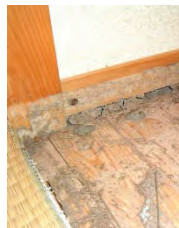
和室畳と床板の蟻害
