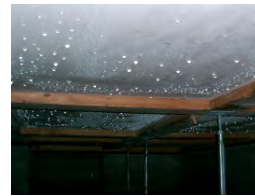
床断熱材の結露と木部の湿潤
