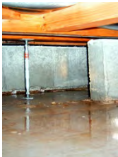
基礎床下浸水事例
