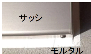
写真 8.3.1 サッシまわりシーリング
