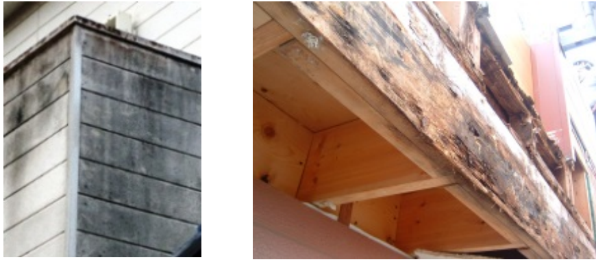
写真4.4.1 バルコニーの不具合事例
