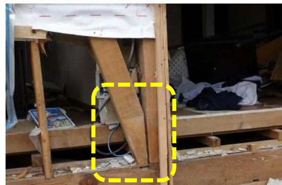
写真15 写真16のアパートの柱脚部 （柱脚、筋かい端部は釘打ちのみ）
