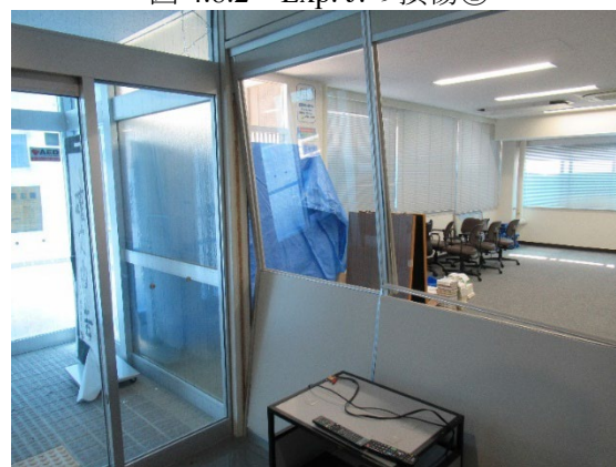
図 4.8.4 間仕切りの損傷
