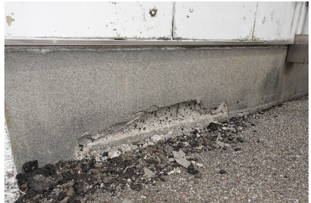
図 4.5.4 上部構造基部のコンクリートの剥落 (建築物 E-1)
