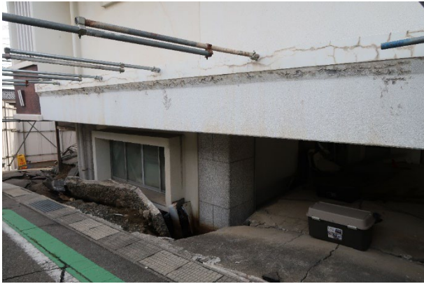
図 4.2.4 X4 構面 1 階部分の沈下
