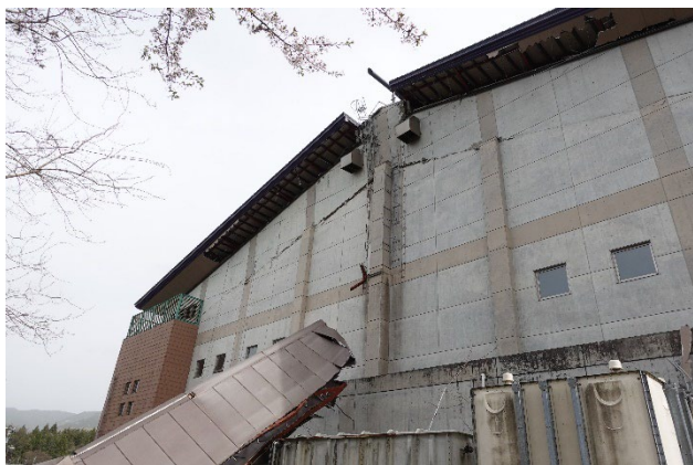
図 5.2.13 妻構面の RC 造壁の面外破壊①
