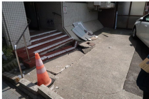
図 4.12.3 東側入り口部の周辺地盤沈下
