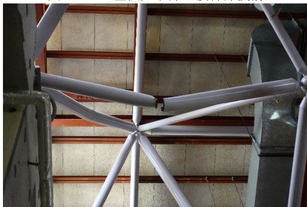
図 5.2.20 システムトラス屋根の主部材の座屈及び破断
