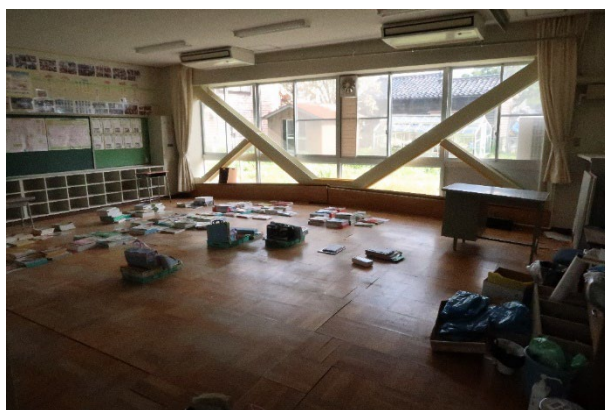
図 4.4.9 建築物 D-1 内部 1 階床の膨れ上がり
