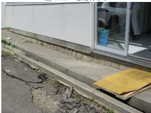
図 4.4.8 周辺地盤の沈下・外構部の被害
