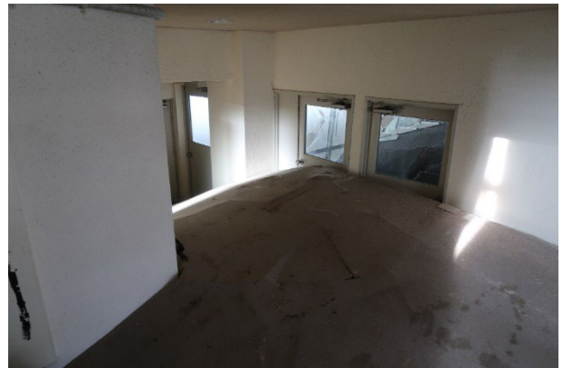
図 4.2.7 Y2~Y3 構面 1 階床の膨れ上がり
