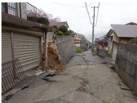
図 5.2.2 地割れの状況①
