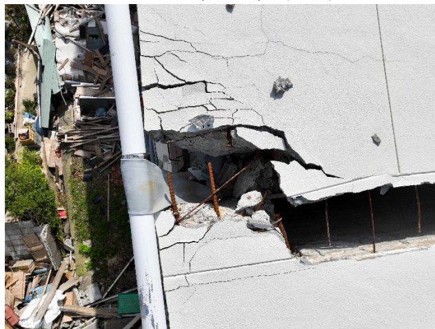
図 4.1.4 西側壁面の損傷（拡大図）
