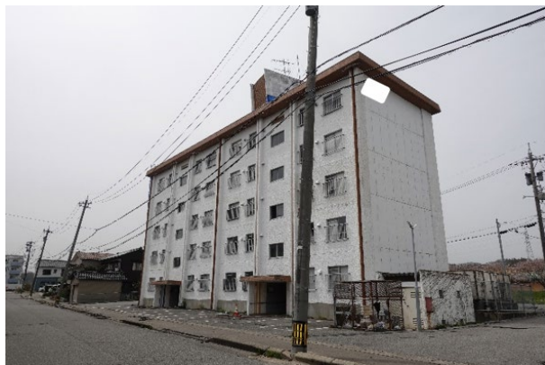
図 4.5.3 建築物 E-1 外観および塔屋の傾斜
