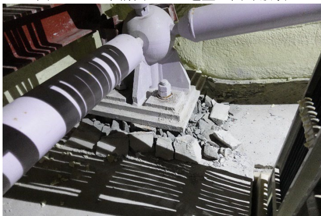
図 5.2.17 屋根支承部のモルタルの損傷
