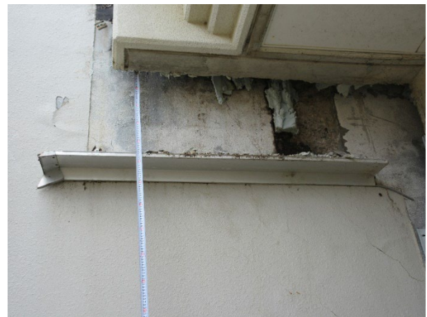
図 4.4.13 建築物 D-2 と別棟の Exp. J.の段差
