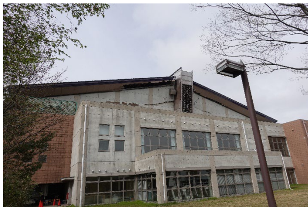
図 5.2.14 妻構面の RC 造壁の面外破壊②
