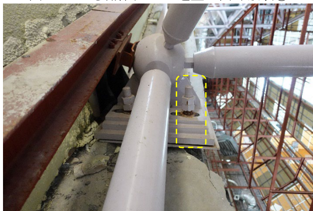
図 5.2.16 屋根支承部のアンカーボルトの伸び
