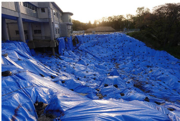
図 4.13.1 地盤崩落の状況
