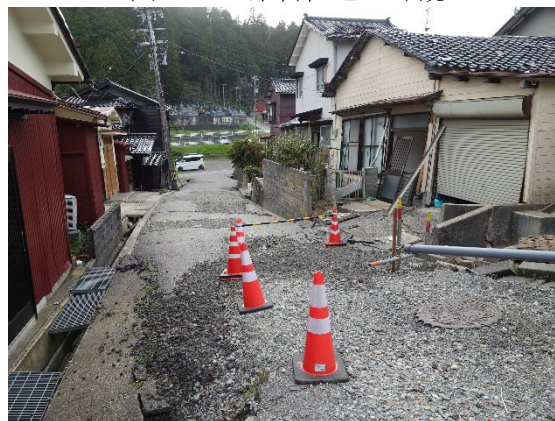
図 5.2.7 地割れの状況②
