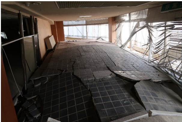
図 4.2.6 Y1~Y2 構面 1 階床の膨れ上がり
