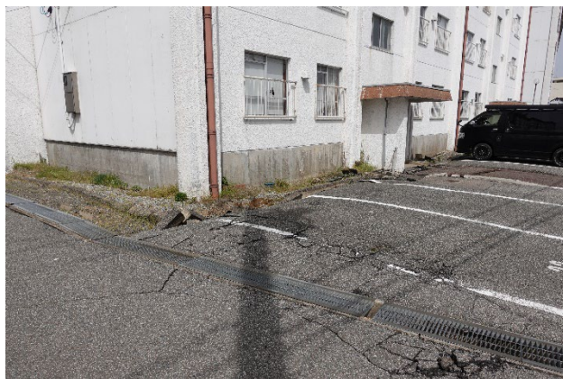
図 4.5.7 建築物 E-2 東側の地盤変状
