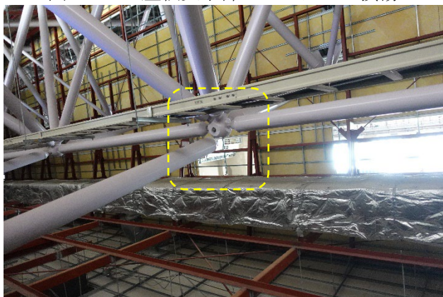
図 5.2.19 システムトラス屋根のポールジョイント部での破断
