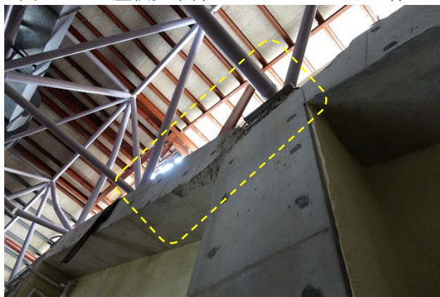
図 5.2.18 屋根支承部の接合部損傷
