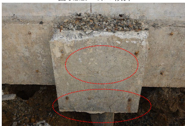
図 5.2.31 パイルキャップの杭頭近傍位置及びパイルキャップ中央位置でのひび割れ
