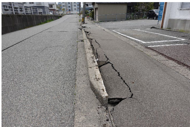
図 4.5.5 建築物 E-1 東側の地盤変状
