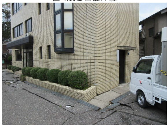
図 4.11.4 周辺地盤の沈下と外構部損傷
