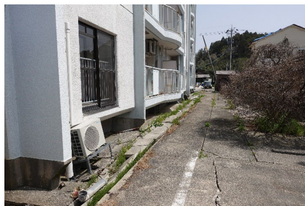
図 4.6.3 建築物周辺の地盤変状
