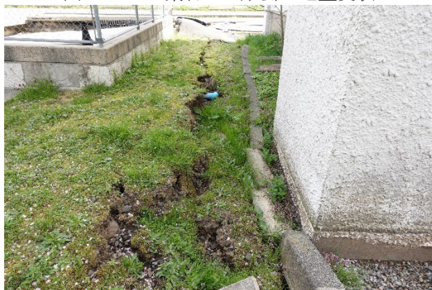
図 4.5.9 建築物 E-3 北側の地盤変状
