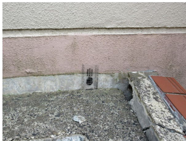
図 4.10.3 周辺地盤の沈下
