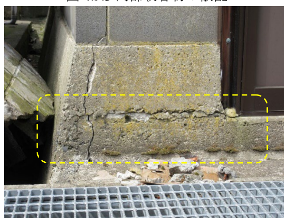
図 4.9.5 建築物 I-2 基礎部の亀裂
