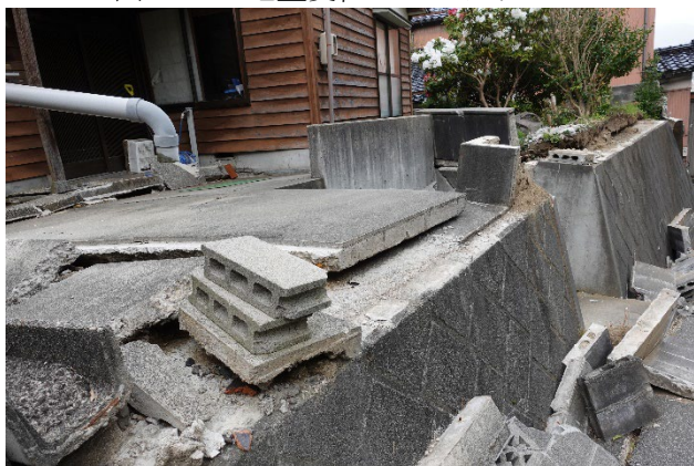
図 5.2.6 土間等の変状
