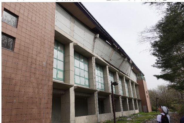
図 5.2.15 平構面の RC 造壁の面外破壊
