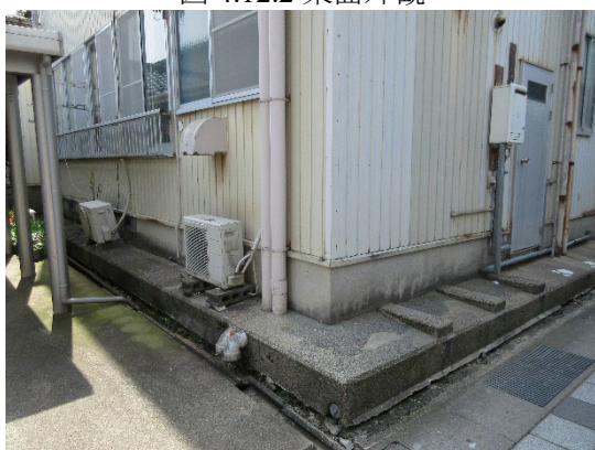
図 4.12.4 西側の周辺地盤沈下
