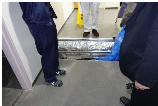
図 4.8.2 Exp. J.の損傷①
