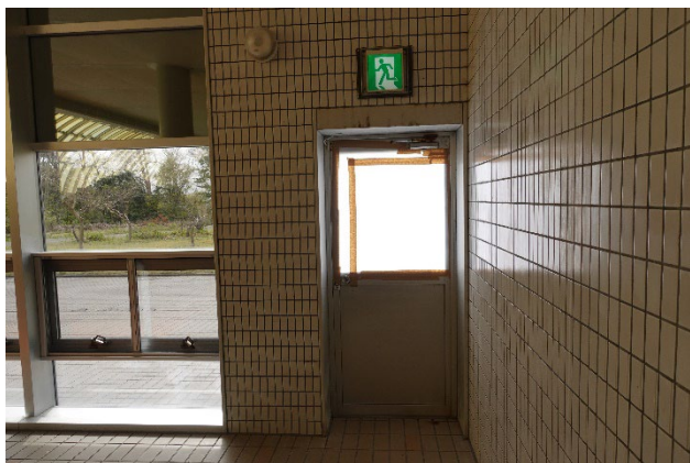
図 5.2.22 建築物 N-2 のドアのガラスの割れ
