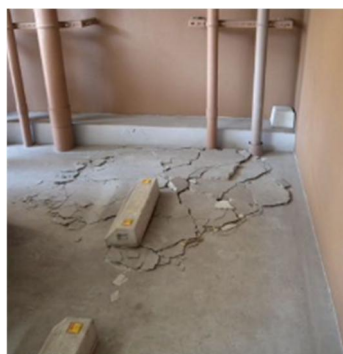
図 4.3.2-1 2016 年の調査における床スラブの被害
