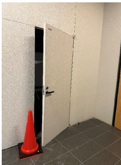
図 4.1.1-10 扉の開閉の支障（1階）
