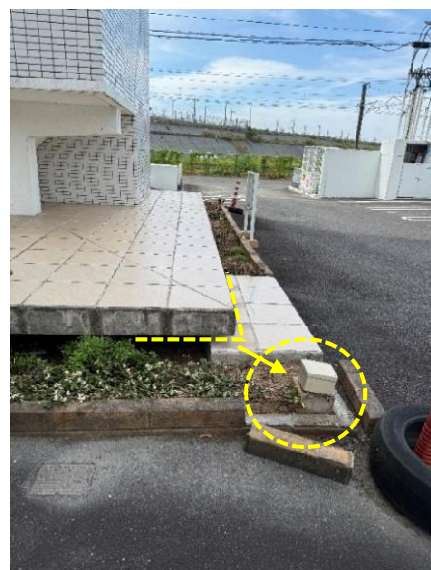
図 4.1.2-6 免震クリアランス内の電灯の破損
