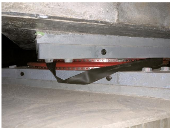
図 4.2.3-4 球面すべり支承の防塵カバーの外れ
