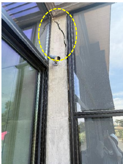
10 図 4.1.1-11 コンクリート製パネルの亀裂
