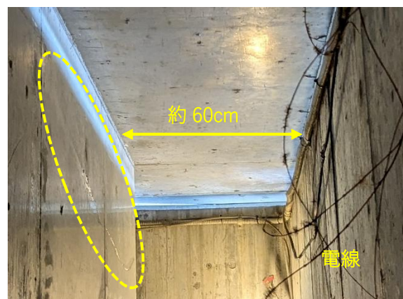
図 4.1.2-2 免震上部基礎と擁壁との接触痕
