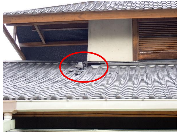
写真 2.1.8 一部の瓦の被害
