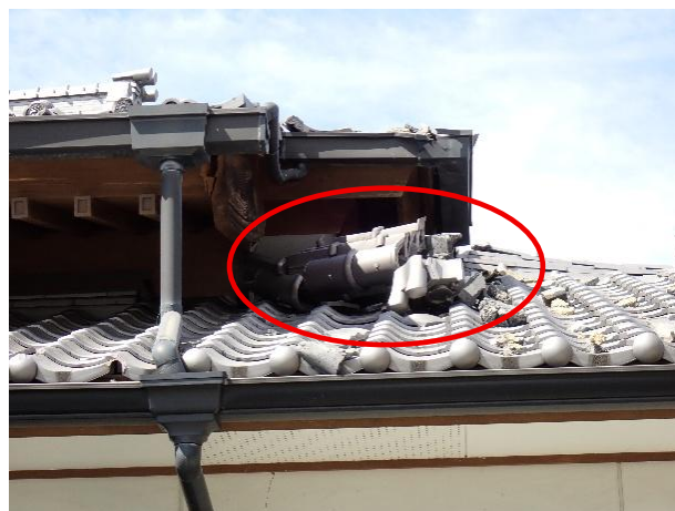
写真 2.4.2 冠瓦とのし瓦が一体となって脱落した状況（寺社 A）
