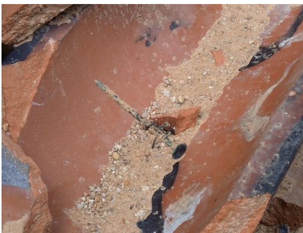
写真 2.3.6 棟瓦に連結されていた釘の状況
