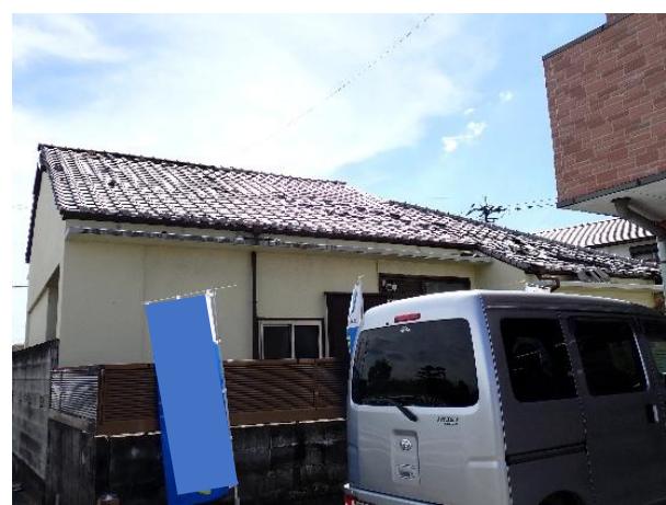
写真 2.2.8 棧瓦のずれと脱落
