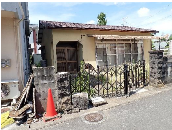
写真 2.2.1 外壁、建具等の被害（住宅 A）
