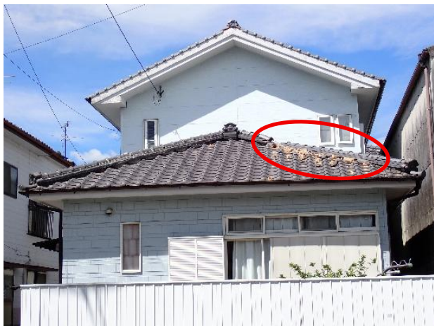
写真 2.2.3 隅棟部分の被害 (住宅 B)
