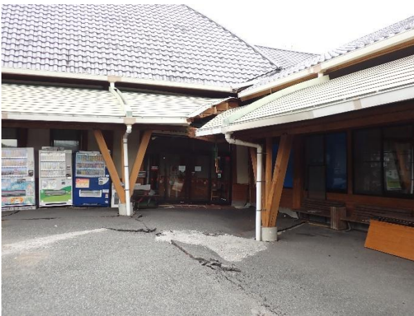
写真 2.1.3 地盤変状と屋根の分離
