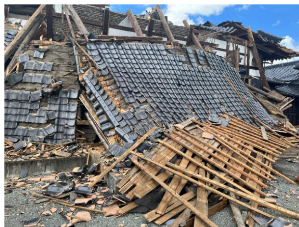
写真 2.4.4 崩落した屋根の状況（寺社 B）
