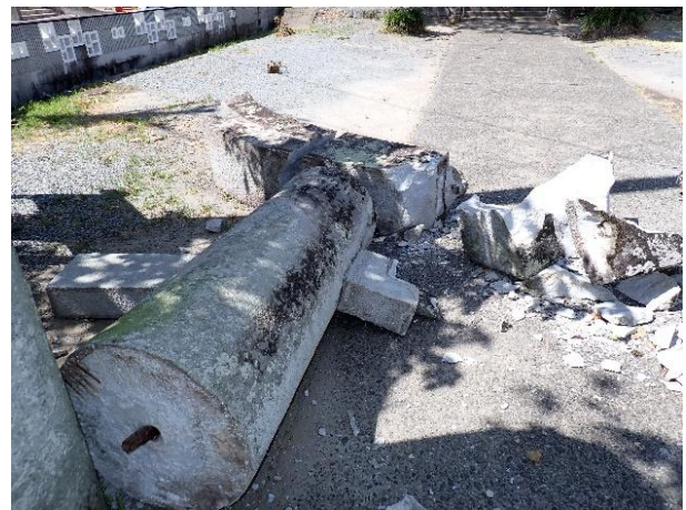
写真 3.4 鳥居の倒壊（宇城市松橋町松橋）
