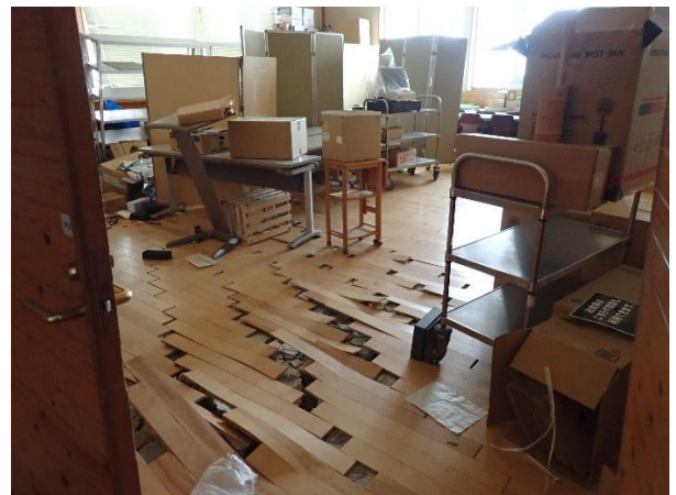
写真 2.1.6 床面の連続した亀裂
