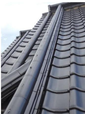
写真 2.3.3 屋根の降り棟部の状況（住宅 E）
