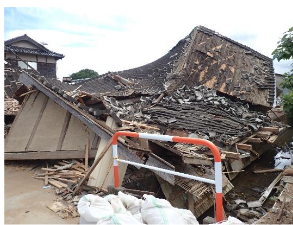
写真 2.3.4 屋根の崩落被害
