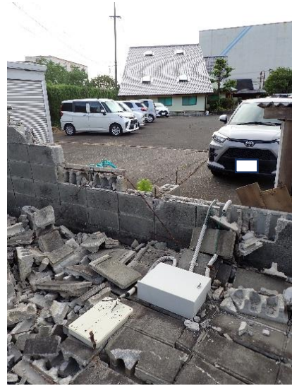
写真 3.2 ブロック塀の倒壊（八代市日置町）
