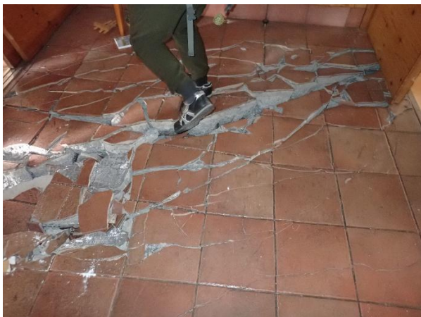
写真 2.1.5 床面の連続した亀裂
