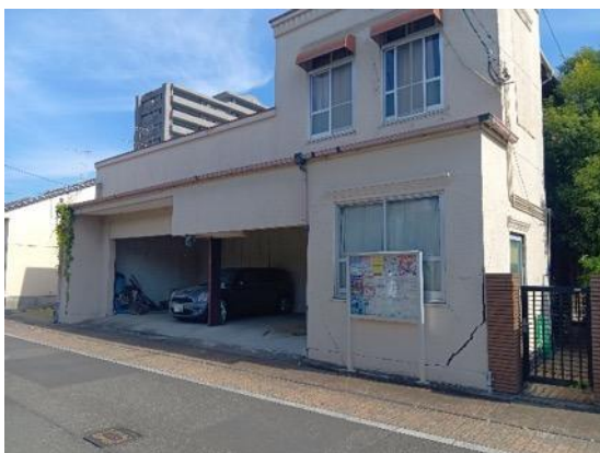
写真 8.2.9 住宅外壁の割れ
