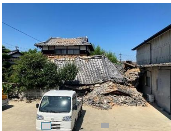
写真 6.2.1 氷川町鹿島の倒壊家屋
