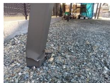
写真 6.2.8b 写真 6.2.8a に○で示した柱の変形
