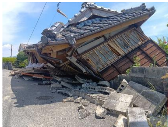
写真 7.2.4 木造住宅の倒壊
