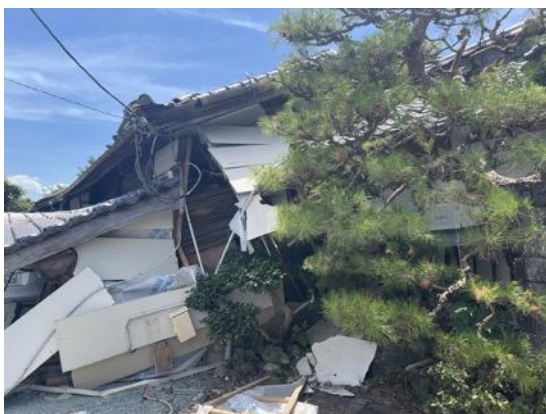
写真 7.2.6b 増築部分の倒壊
