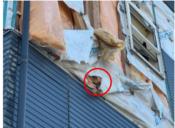
写真 5.2.9b 露出した筋かい端部金物
