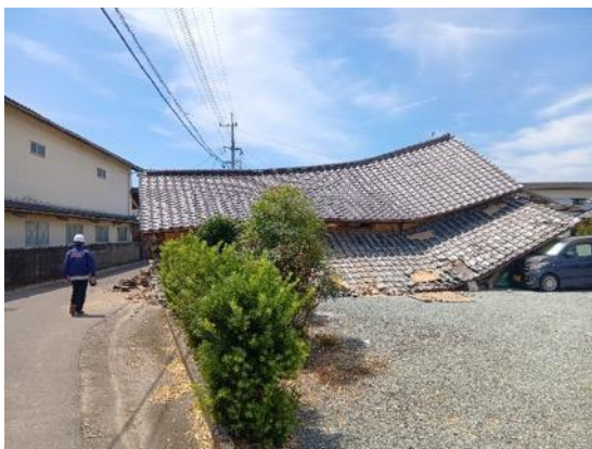
写真 7.2.3 木造住宅の倒壊
