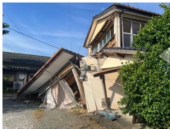
写真 7.2.2 木造住宅の倒壊
