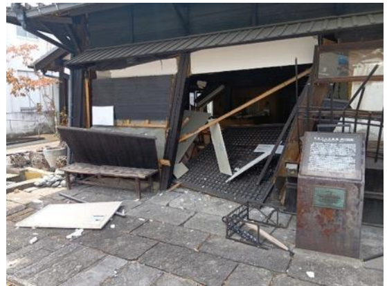
写真 7.2.10 正面開口部の損傷
