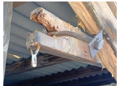
写真 5.2.10c 変形した羽子板 ボルト
