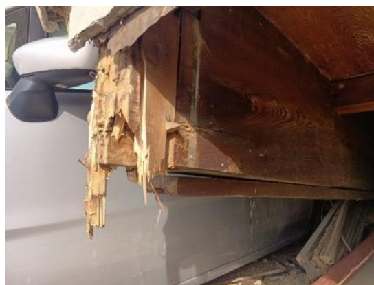
写真 8.2.22 通し柱-大梁の接合部での破断
