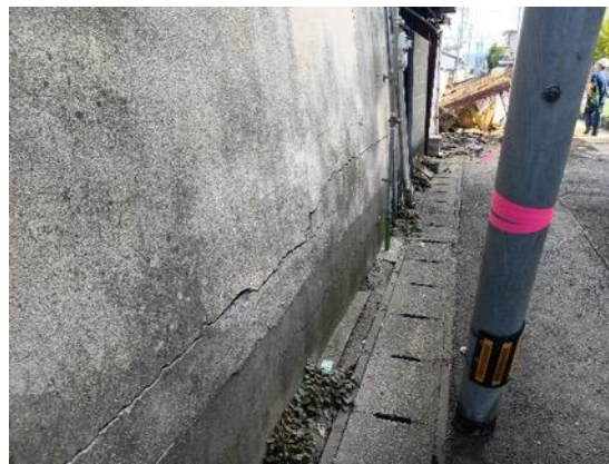
写真 8.2.4 隣接する建物の外壁ひび割れ
