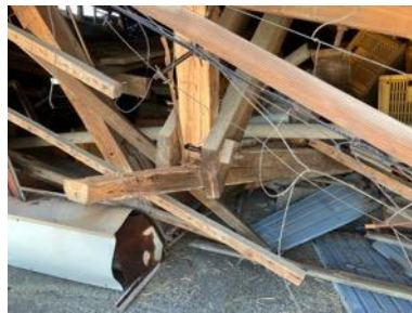
写真 5.2.10b 釘うちのみで接 合された筋かい
