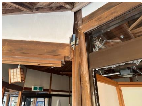
写真 9.2.1d 梁端部の脱落
