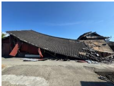
写真 5.2.10a 倒壊した納屋
