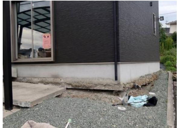
写真 A.2 地盤沈下に伴う基礎周辺の地盤変状 (国土技術政策総合研究所三木氏提供)
