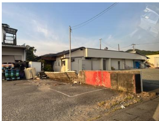
写真 9.2.3 周辺のブロック塀被害
