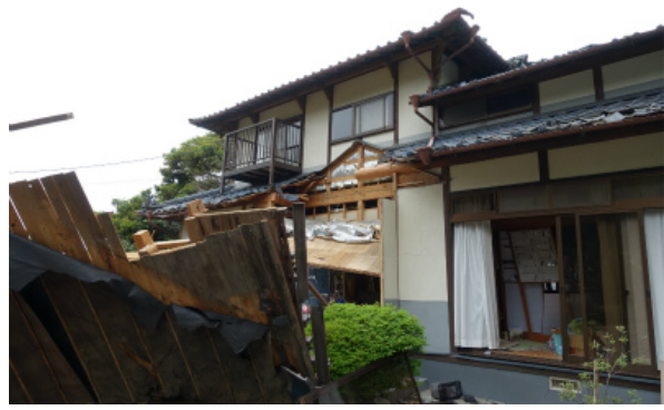
写真 5. 3-29 玄関部分が部分破壊した木造住宅
