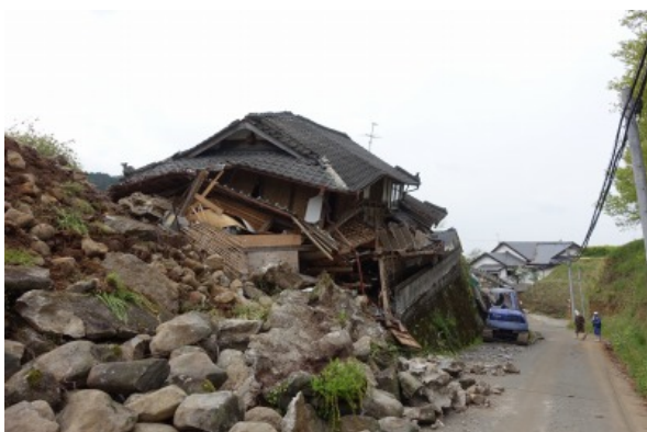
写真 5.3-40 倒壊した木造住宅
