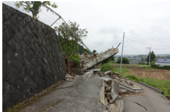
写真 5. 3-31 崩壊した擁壁
