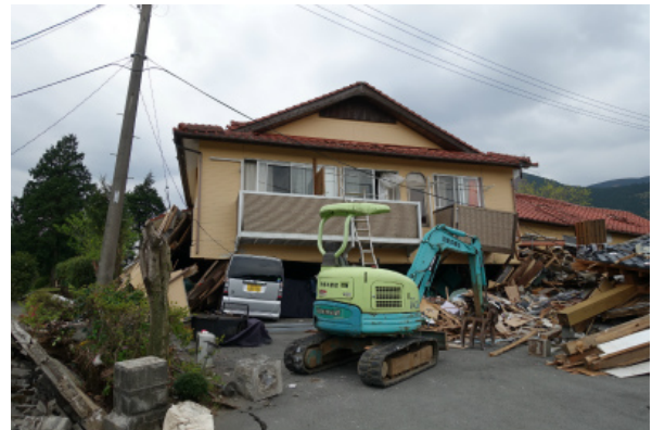
写真 5.3-65 倒壊した木造住宅
