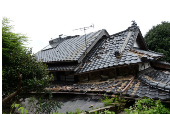
写真 5. 3-26 倒壊した木造住宅
