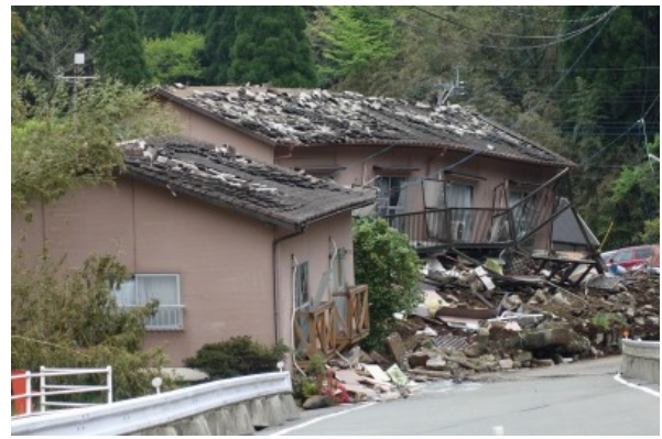
写真 5.3-63 倒壊した木造アパート
