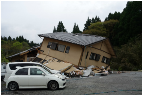
写真 5.3-64 倒壊した木造住宅
