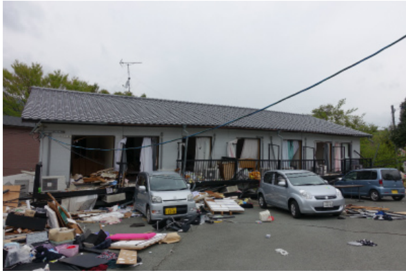
写真 5.3-46 倒壊したアパート A
