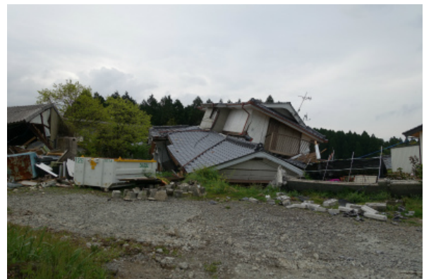
写真 5.3-67 倒壊した木造住宅
