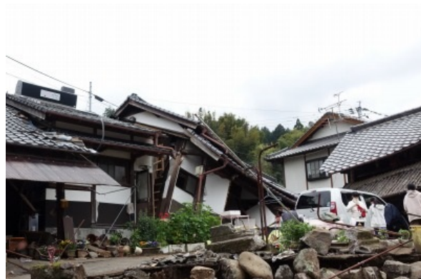
写真 5.3-39 倒壊した木造住宅
