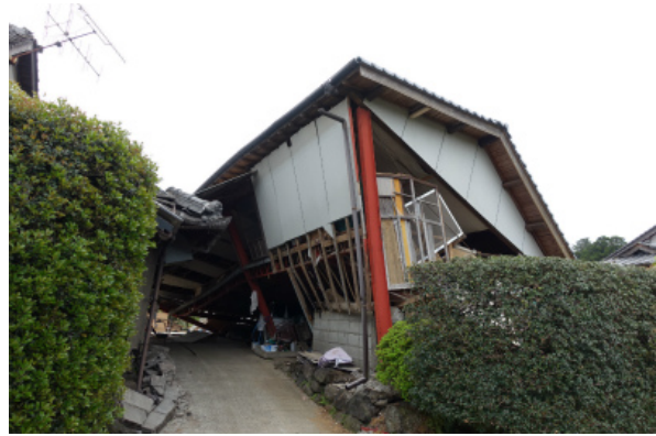
写真 5.3-45 倒壊した倉庫
