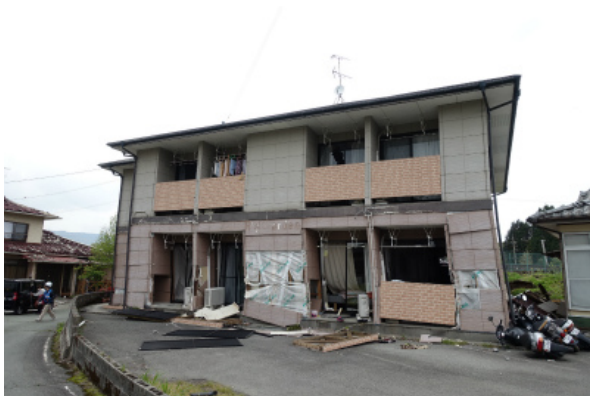
写真 5.3-60 傾斜した木造アパート
