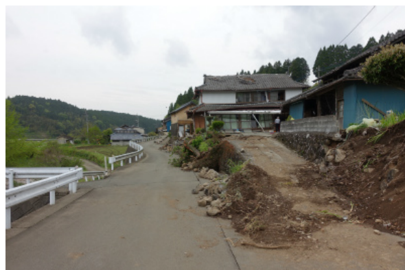
写真 5.3-41 崩壊した擁壁
