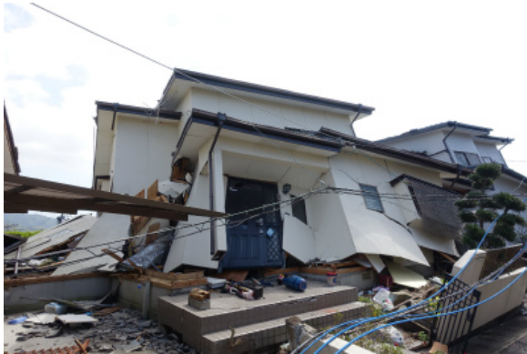
写真 5.3-8 倒壊した木造住宅
