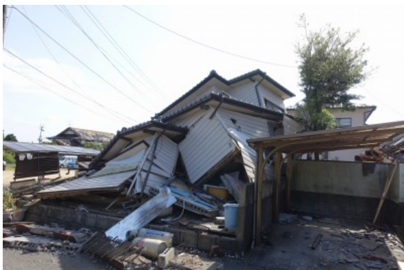
写真 5.3-12 倒壊した木造住宅
