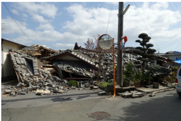
写真 5.3-2 倒壊した木造住宅
