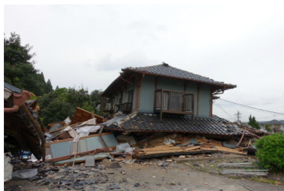
写真 5. 3-27 倒壊した木造住宅
