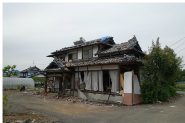
写真 5.3-43 大破した木造住宅
