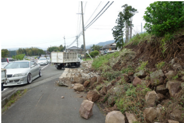
写真 5. 3-30 崩壊した擁壁
