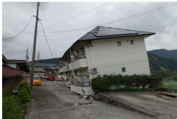
写真 5.3-59 横ずれした木造アパート
