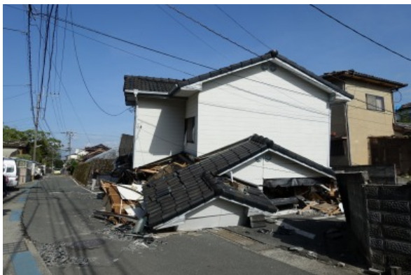
写真 5.3-10 倒壊した木造住宅
