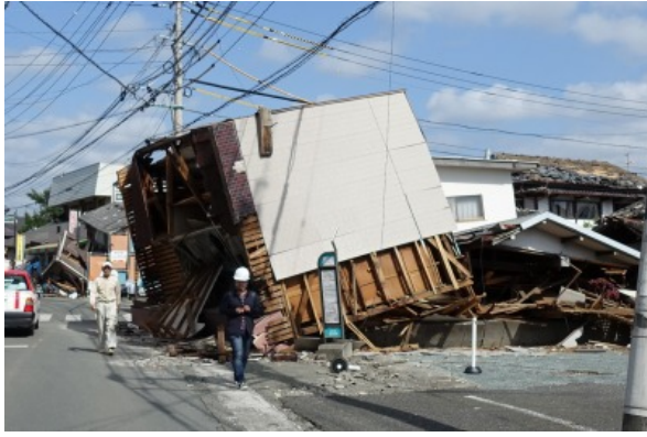
写真 5.3-6 倒壊した店舗併用木造住宅
