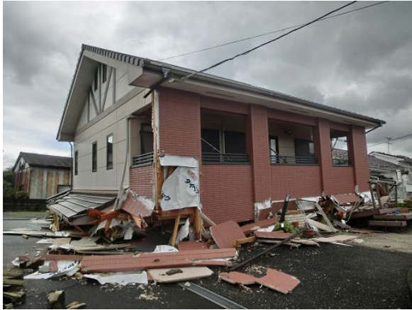
写真5.3-20 倒壊した木造住宅
