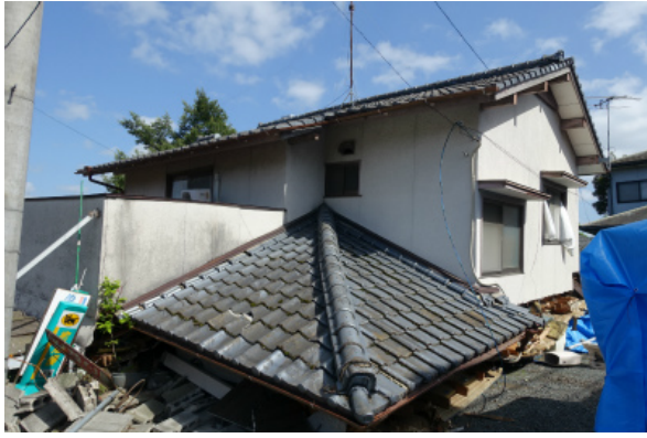
写真 5. 3-14 倒壊した木造住宅
