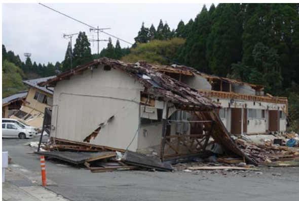
写真 5.3-54 倒壊した木造アパート D
