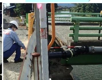
⑦宇城市添架管破断(修繕済み)
