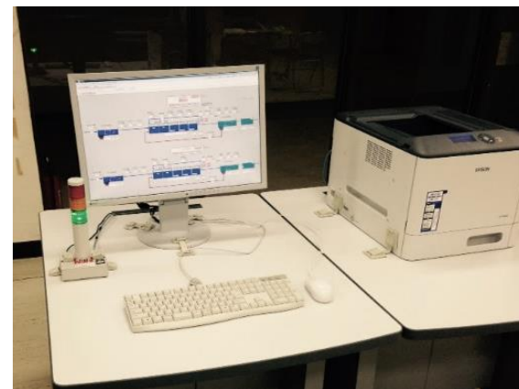
監視制御装置・ 監視制御画面
