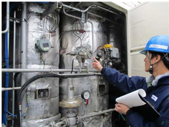
水素製造装置点検
