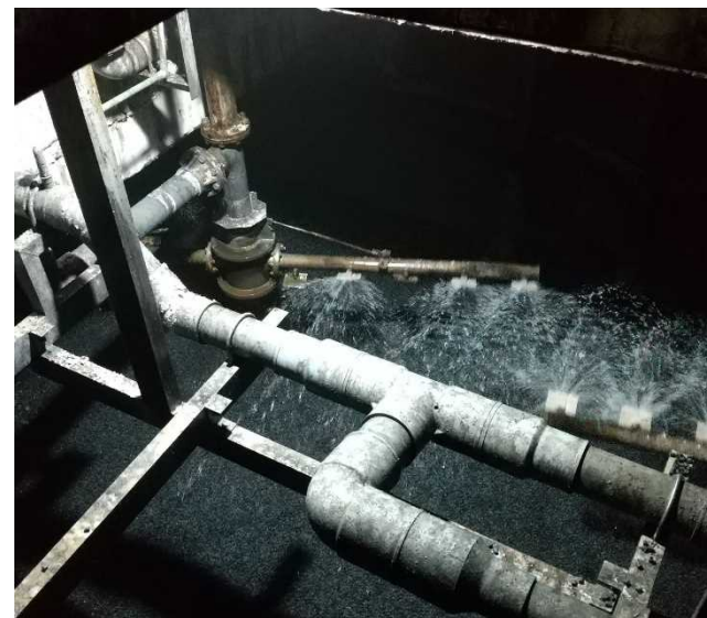
散水担体ろ床槽内散水機 (撮影:2021年12月)
