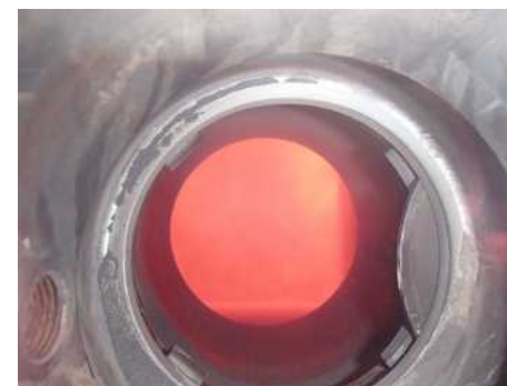
炉内燃焼状況
