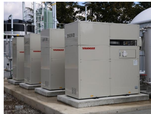
消化ガス発電設備
