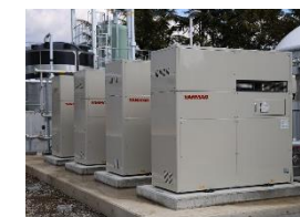
消化ガス発電施設の整備
