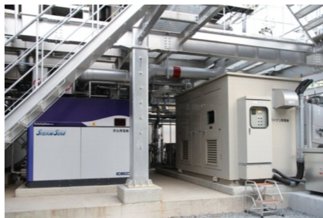
小型蒸気発電機＋バイナリ発電機
