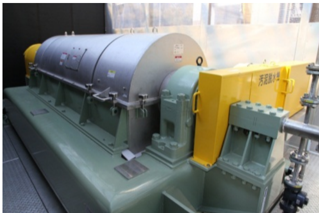
低含水率化脱水設備 (定格能力: 15m 3 /h)
