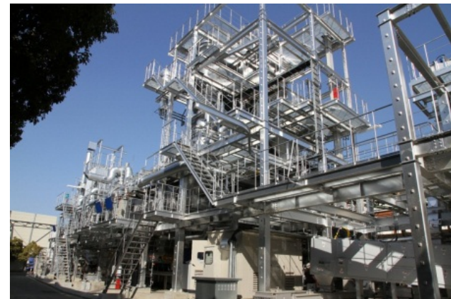
廃熱ボイラ付 革新型階段炉設備 (定格能力: 35t/d)
