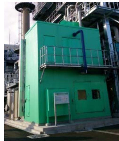
高効率排熱発電設備 (定格能力: 25kW)
