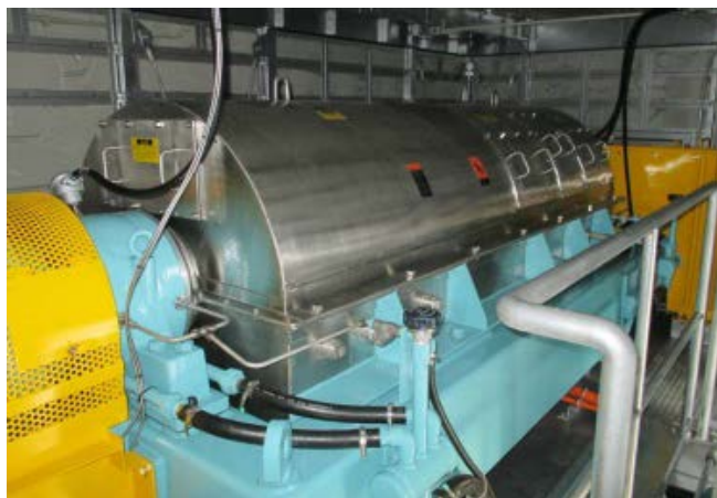
低含水脱水設備 (定格能力: 20m 3 /h)
