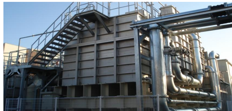
超高効率固液分離槽外観@中浜B-DASH実験設備
