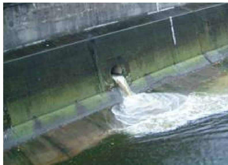
雨水吐からの放流状況
