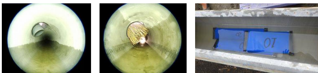
図-4 断面障害部の模擬状況 (左:取付け管突出し、中:樹木根侵入、右:土砂堆積)
