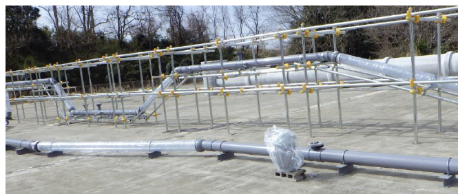
図-5 水平方向の曲がり部（手前左側）及び鉛直方向の曲がり部（奥）
