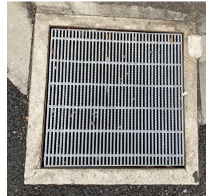
雨水浸透柵外観 (A自治体)
