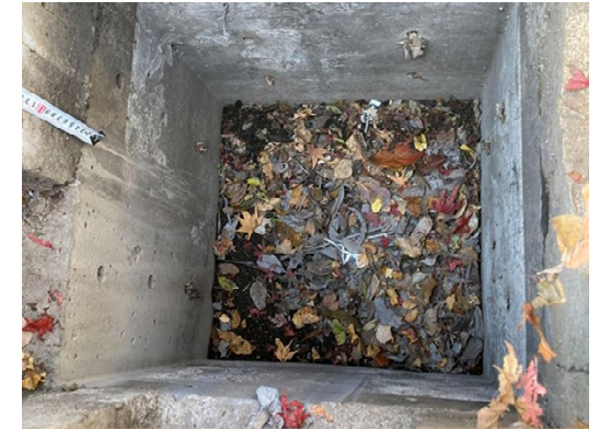
雨水浸透柵内部 (A自治体)
