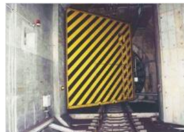
トンネル内防水ゲート
