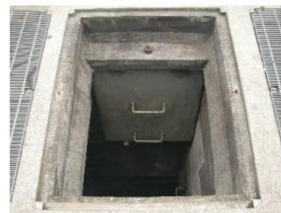
浸水防止機「開」状態
