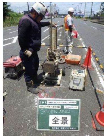
貫入試験による空洞調査
