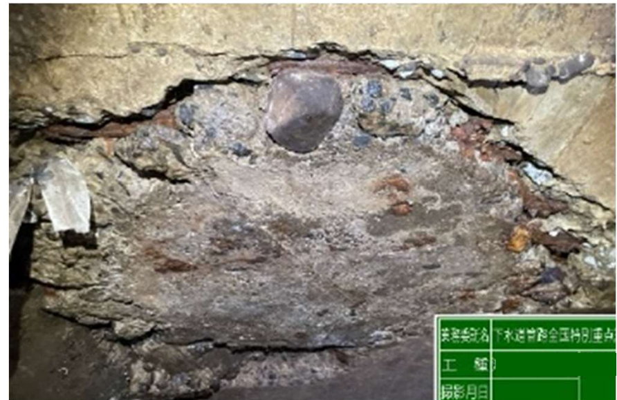
管の破損・クラックから緊急度 I と判定
