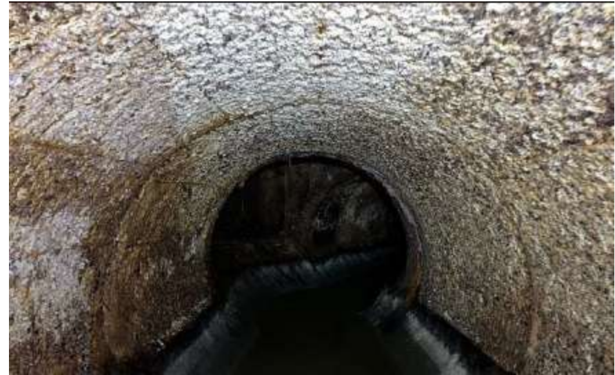
管の腐食から緊急度 I と判定
