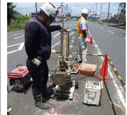
貫入試験による空洞調査
