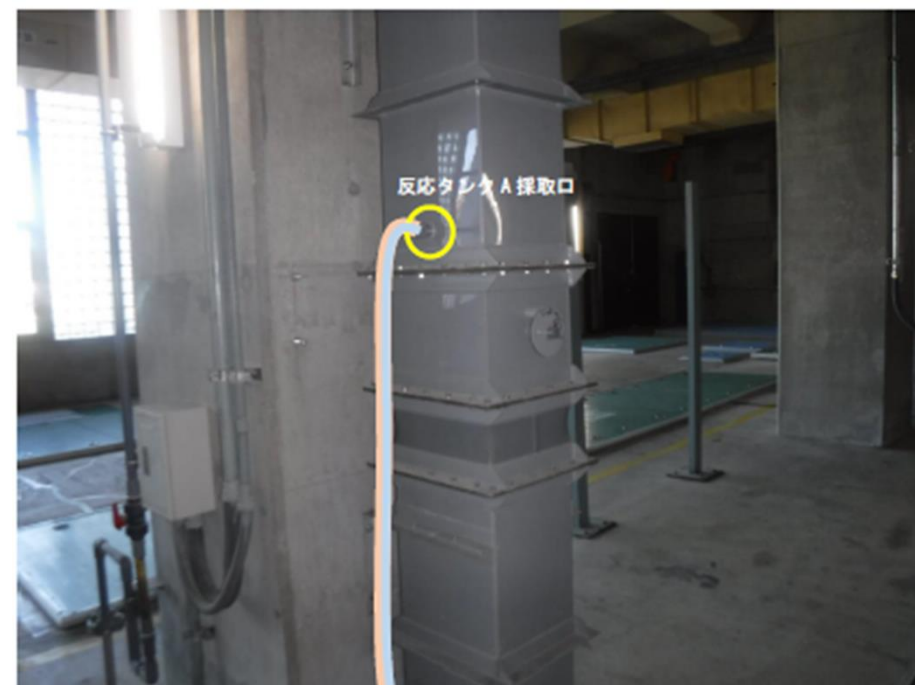
排気ダクトからの配管の様子 (横浜市からの提供)
