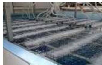
超微細散気装置導入による省エネ化 (○○○t-CO 2 削減)
