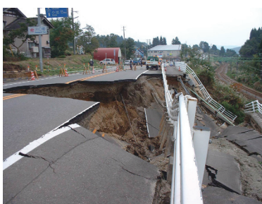
新潟県中越地震による道路崩壊 出典：「土木研究所ホームページより」
