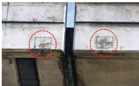
写真-1.1.2 ひびわれ, 漏水(後打ち部)
