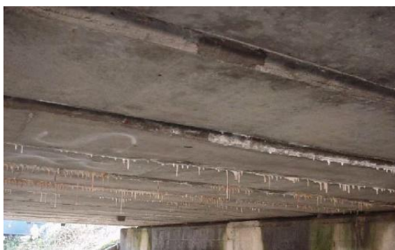
写真-1.1.1 遊離石灰(間詰め部)
