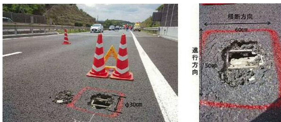
図- 4.1.1 舗装および床版の陥没状況
