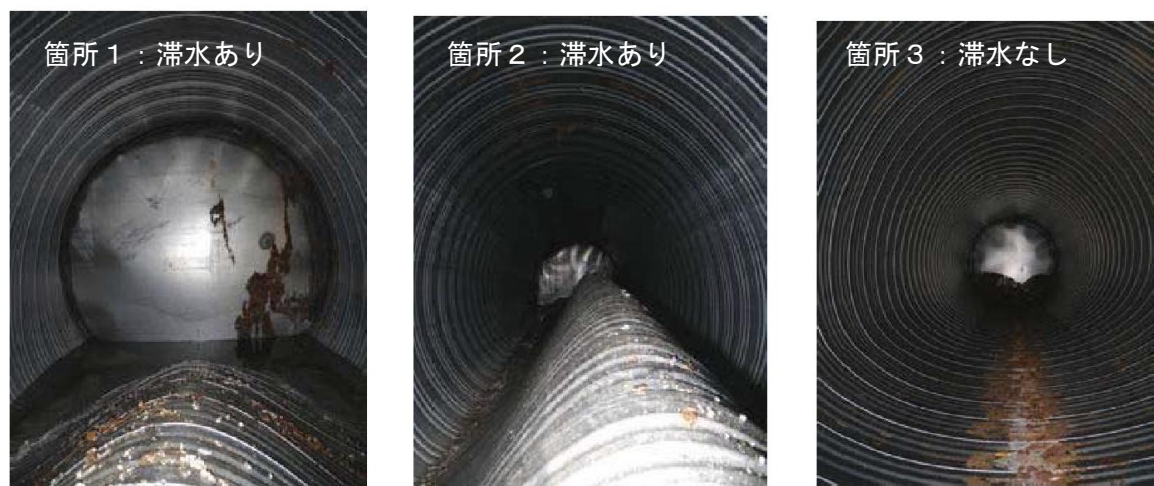
写真- 4.3.3 中空型枠内の滞水状況
