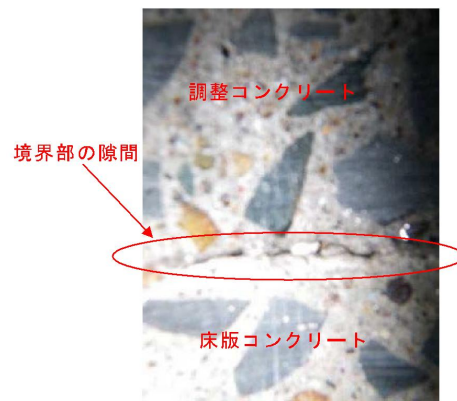
写真- 4.3.4 境界部の隙間
