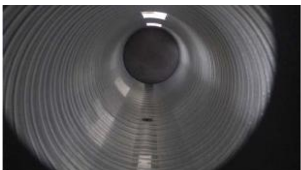
据付勾配 2.0% 第 1, 2 孔開栓 滞水状況（妻枠）
