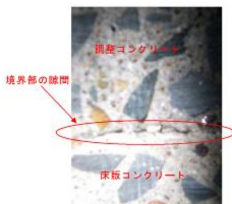
写真- 2.2.1 境界部の隙間
