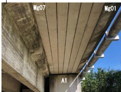
写真 6. 汚損（Mg01, Mg07 主桁下面）
