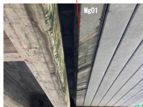
写真 4. 著しい汚損（Mg01 主桁下面）
