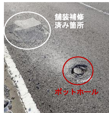
P1-A2 径間 橋面 (P1 付近) ポットホール発生箇所
