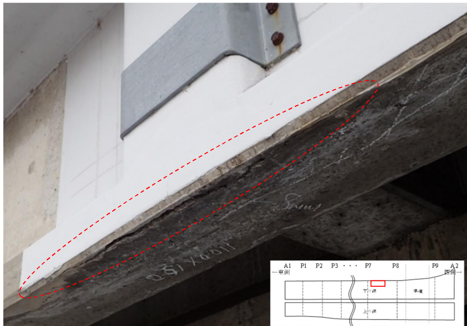
写真-7 G1 桁下フランジの剥離 (P7-P8 径間)
