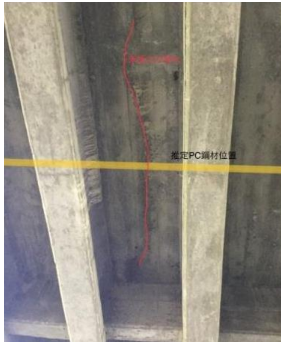
床版部のひびわれ及び遊離石灰
