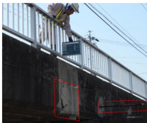
(b) 横締め PC 鋼材突出状況
