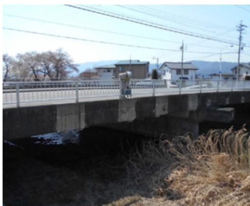
(a) 横締め PC 鋼材突出状況
