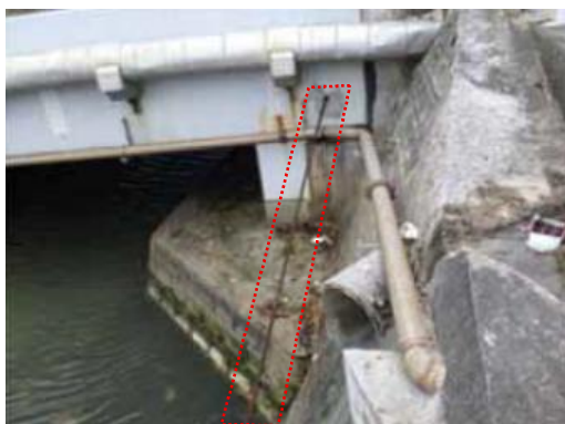
(a) 鋼材突出部（正面）
