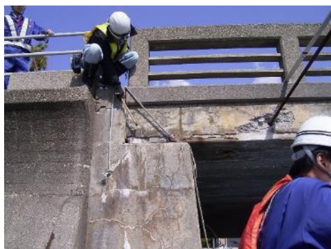
(a) 横締め PC 鋼材突出状況
