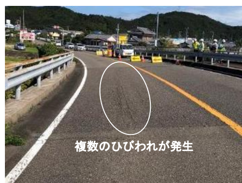
写真 5. 橋面舗装のひびわれ（縦目地部）
