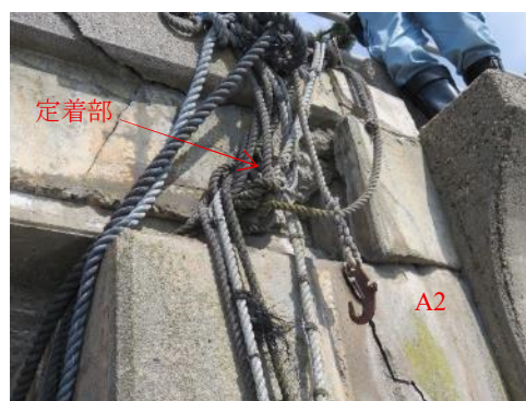
(d) PC 鋼材定着部のコンクリートはく落
