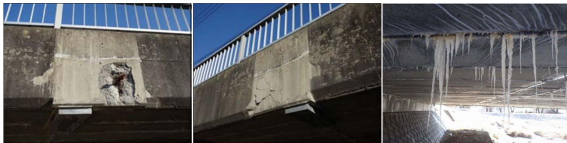
(a) 補修後の PC 鋼材突出
