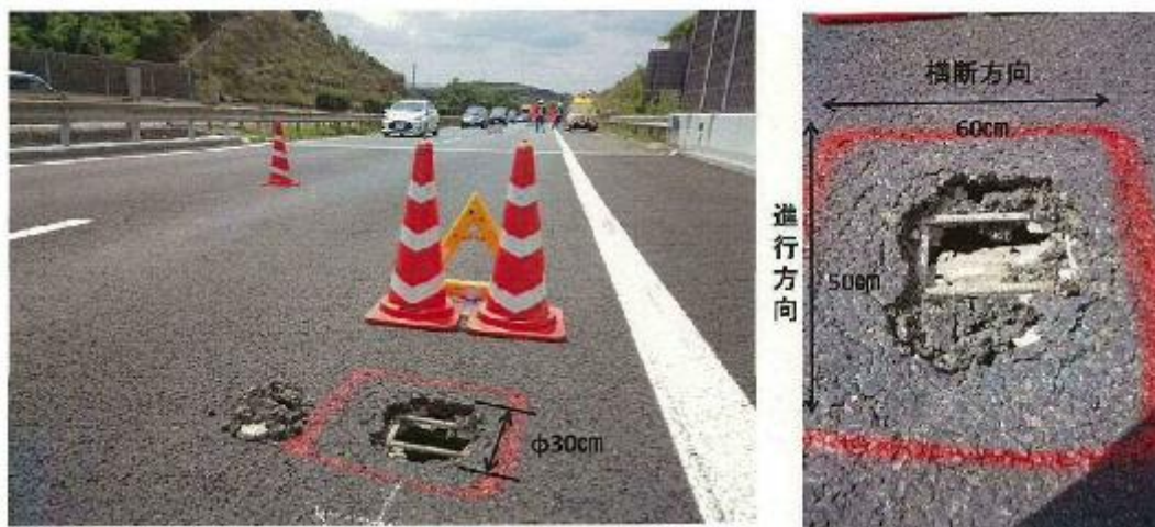
写真- 2.1.1 損傷状況
