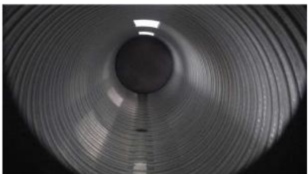
据付勾配 0.1% 第 1 孔開栓 滞水状況（妻枠）
