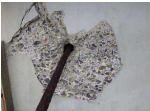
(c) コンクリート片のはく落
