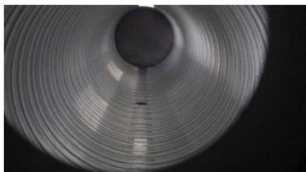
据付勾配 2.0% 第 1 孔開栓 滞水状況（妻枠）
