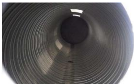
据付勾配 4.0% 第 1, 2 孔開栓 滞水状況（妻枠）
