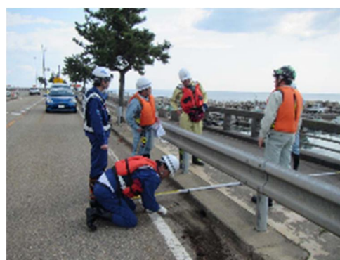
写真- 4.1.7 PC 鋼材破断位置付近の排水桝
