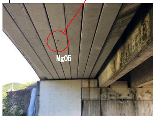
写真 3. 錆汁の痕跡（Mg05 支間中央部）
