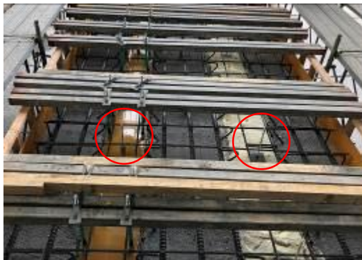
写真- 4.2.8 計測器具設置状況
