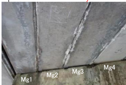
遊離石灰(A1 側)
