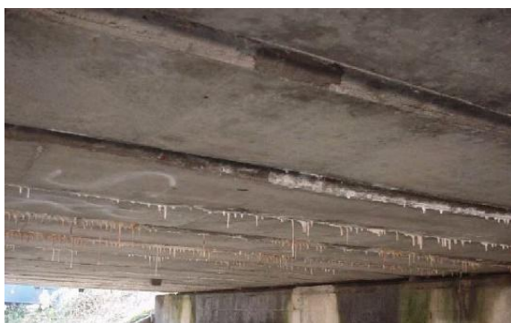
写真-1.1.1 遊離石灰(間詰め部)
