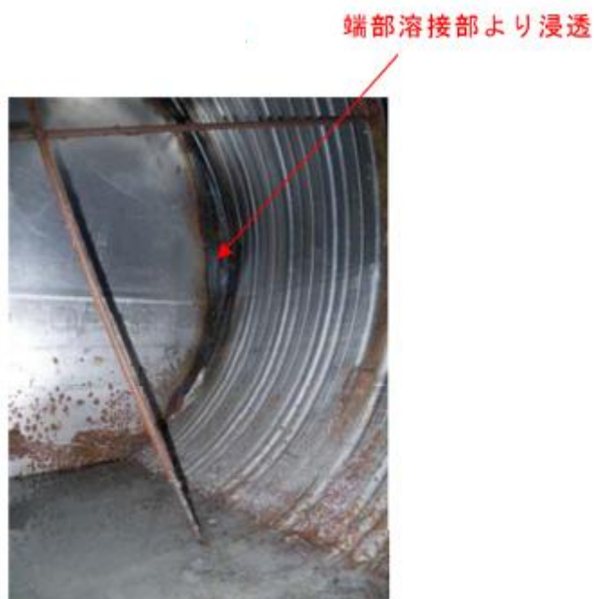
写真-2.2.3 中空型枠内部への溶接部よりの浸水例
