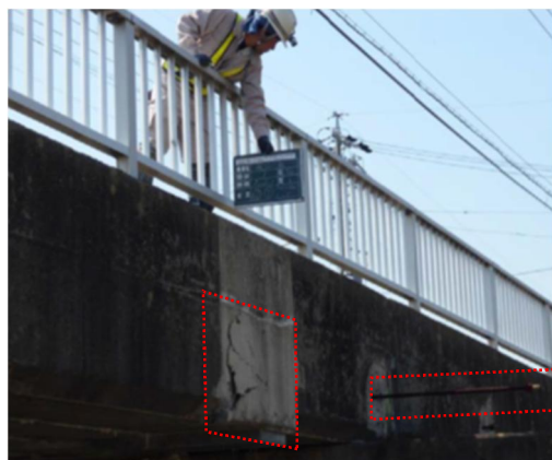
(b) 横締め PC 鋼材突出状況
