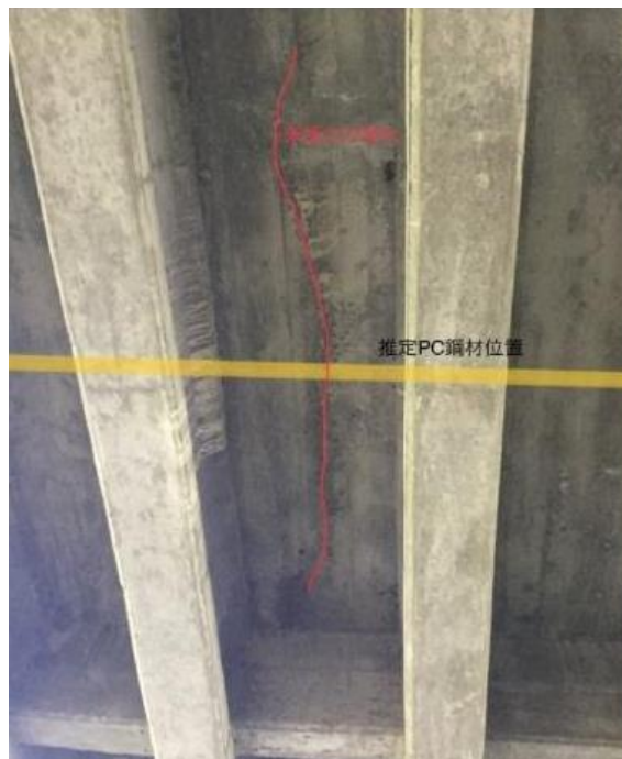
床版部のひびわれ及び遊離石灰
