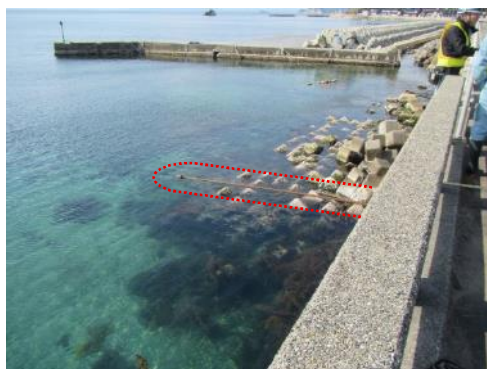
(b) 横締め PC 鋼材突出状況
