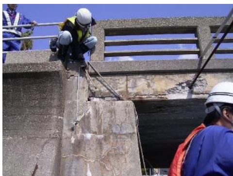
(a) 横締め PC 鋼材突出状況
