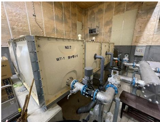
(a) 受水タンク
