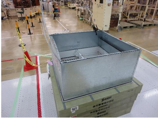
(a) 脱落した排煙口
