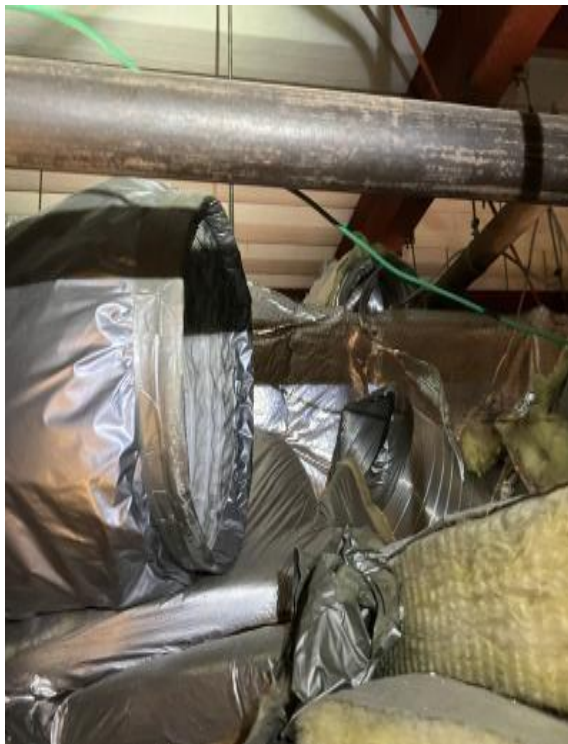
図 4.11.4 ダクトの破断
