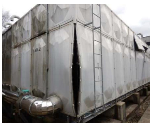
(b) 受水タンク破損状況
