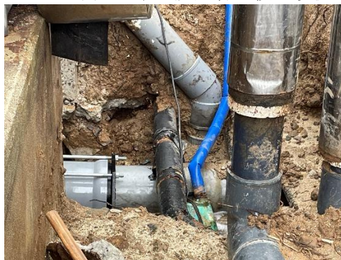
(f) 地中埋設管破断・漏水箇所
