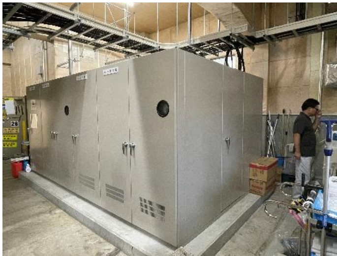
(c) 受変電設備
