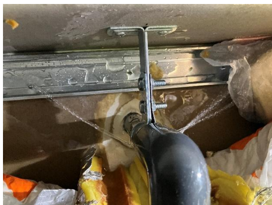
(a) 純水配管の破損
