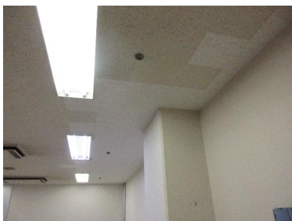
(c) 天井からの漏水跡
