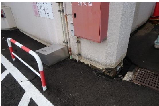
図 4.30.11 外構部の地盤変状
