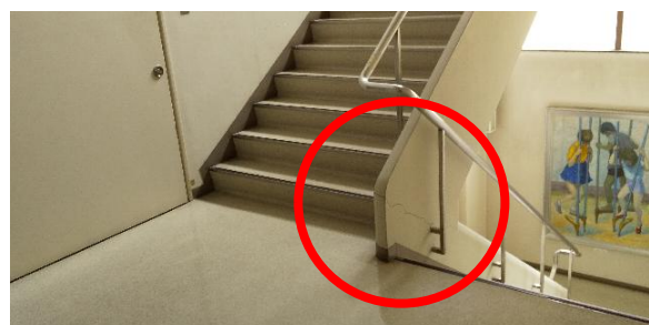
(b) 階段腰壁損傷箇所
