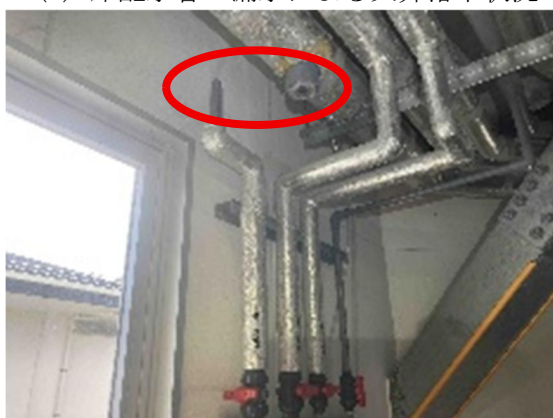
(e) 塩ビ管分岐部の破断状況
