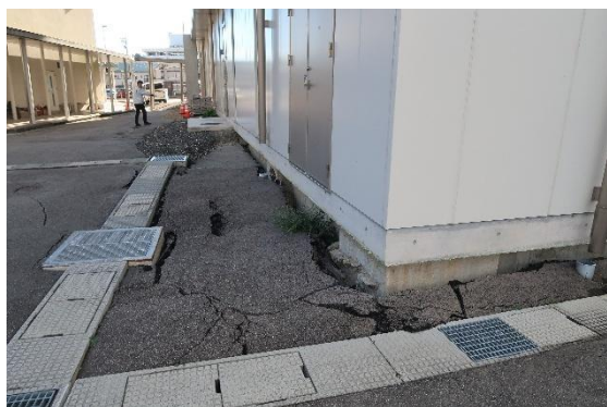
図 4.31.5 外構部の地盤変状
