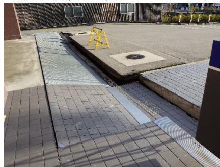
(c) 本館周囲に生じた段差
