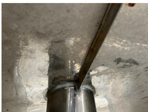
図 4.2.5 ボイラ用補給水タンクの修繕箇所
