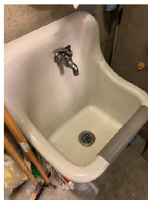
図 4.2.3 水が溢れた掃除用流し
