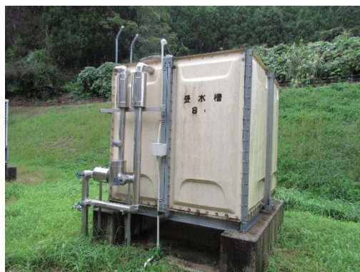
図 4.4.5 屋外受水タンク（建築物 D）
