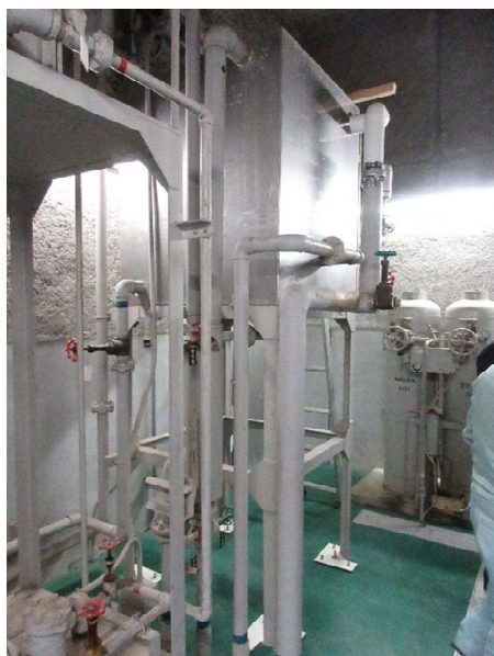
(a) 自家発電設備
