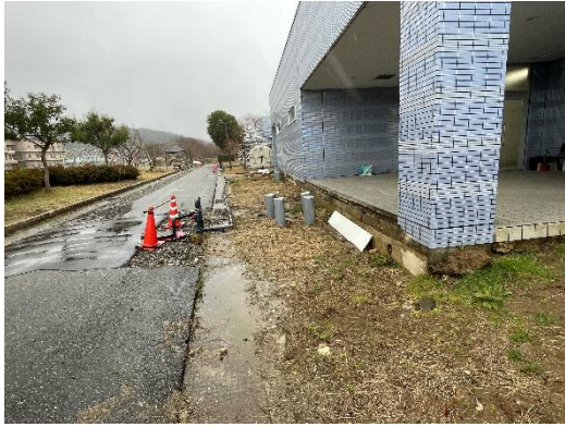
(a) 建築物周囲の地盤沈下、排水桝
