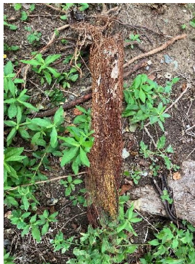
図 4.1.4 配管から取出した根 （建築物 A）
