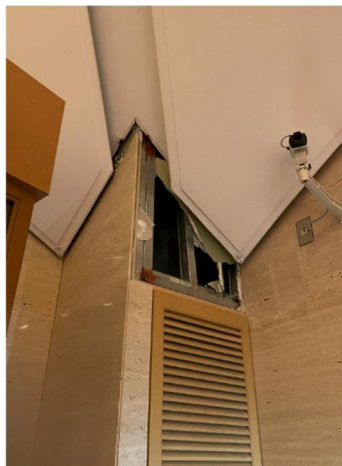
(b) 壁取合い部の損傷
