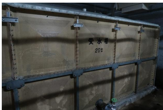
図 4.30.8 受水タンク（建築物 AD-1）
