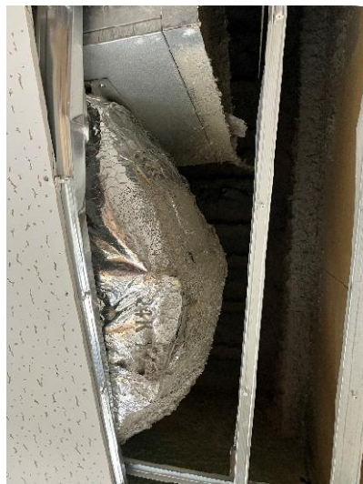
図 4. 26. 7 外調機の落下（建築物 Z）
