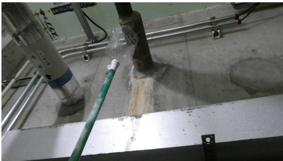
図 4. 9. 5 温泉配管の地中外壁貫通部からの漏水（地下1階）
