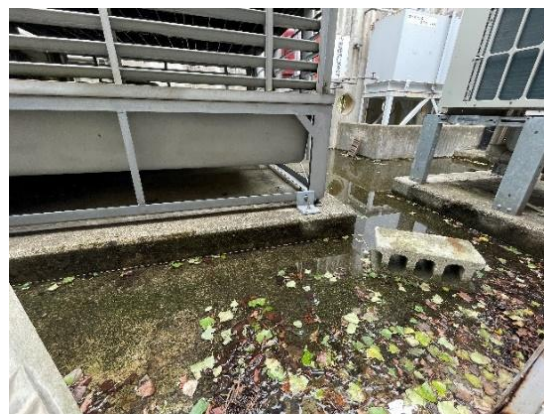
図 4.1.6 冷却塔置場の浸水（建築物 A）
