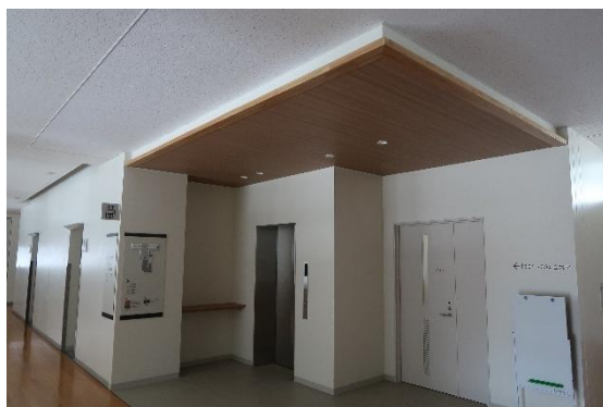
図 4.33.8 増設されたエレベータ
