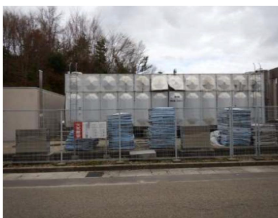
(a) 受水タンク外観
