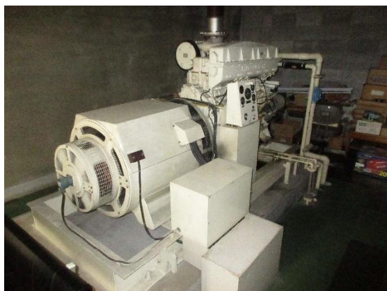
図 4.29.3 自家発電設備
