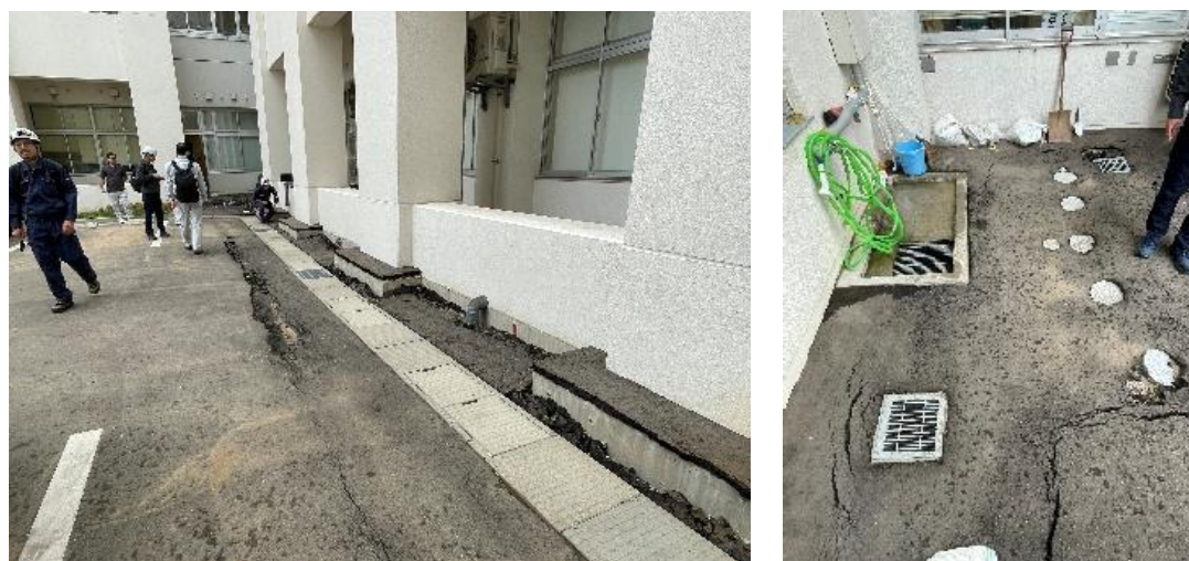
(b) 中庭の地盤沈下の状況
