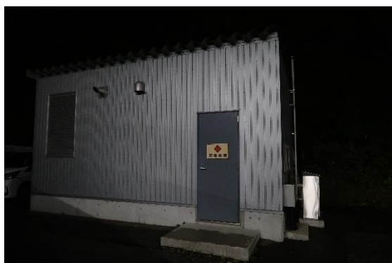
図 4.32.3 自家発電設備小屋
