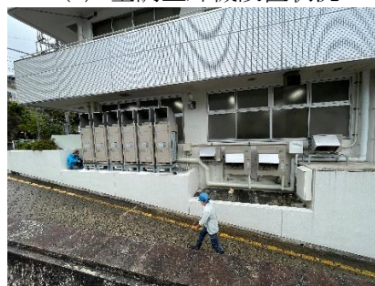
(c) 空調室外機設置状況 3
