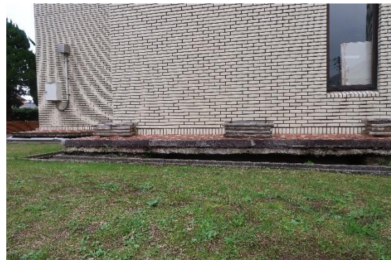
図 4.29.8 建築物 AC 北側の地盤変状
