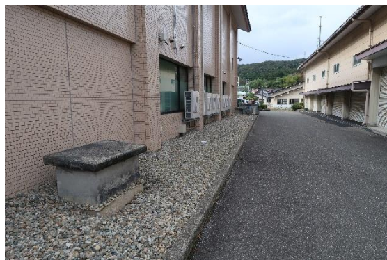
図 4.33.17 建築物 AG-1 北側の地盤変状
