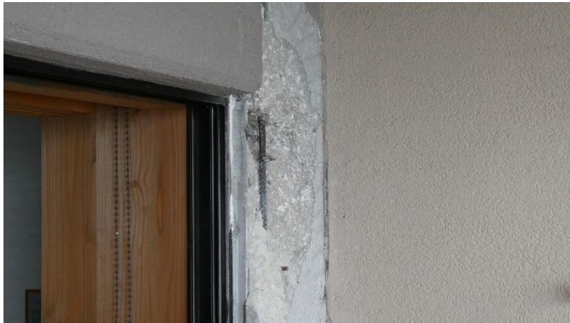
図 4.9.3 鉄筋の露出（屋外より撮影）
