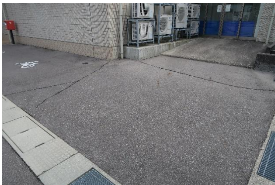
図 4.33.18 建築物 AG-4 周辺の地盤変状
