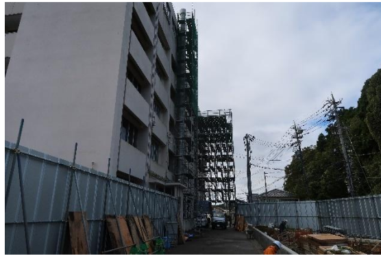
図 4.30.10 ボイラ煙突（建築物 AD-1）
