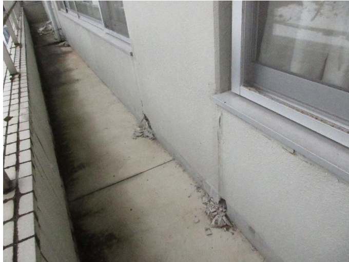
図 4. 26. 3 2階柱脚の圧壊（建築物 Z）
