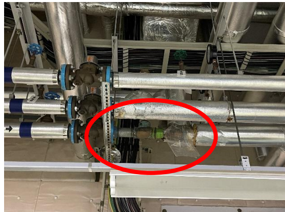
(b) 配管漏水発生個所
