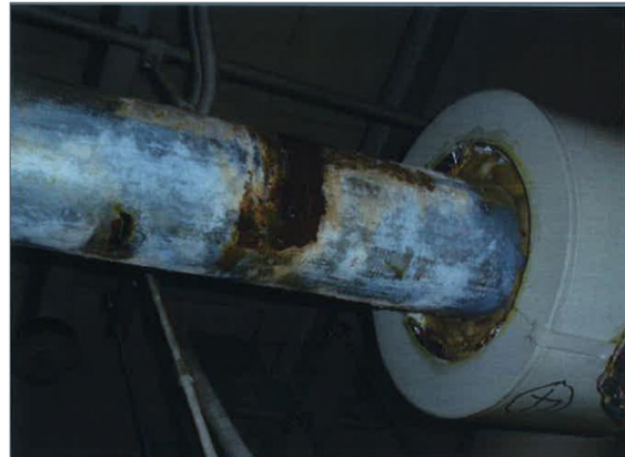
(b) 冷却水配管損傷箇所
