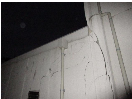
図 4.32.9 塔屋階壁の損傷
