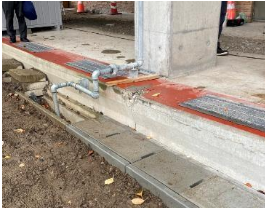
図 4.12.2 地盤沈下で生じた 40 cm の段差
