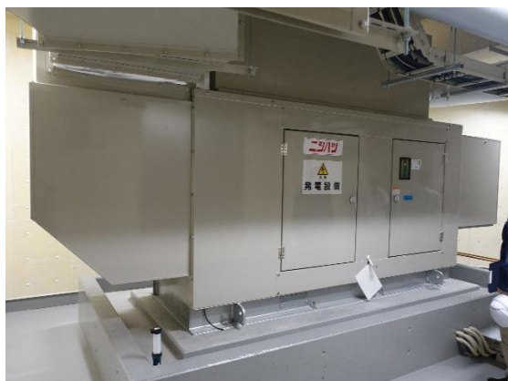
図 4.31.3 自家発電設備
