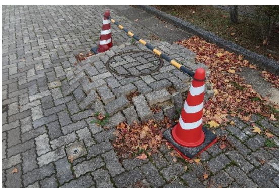
図 4.28.9 建築物 B 西側の地盤変状
