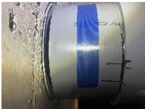
(c) 破断した循環ろ過配管
