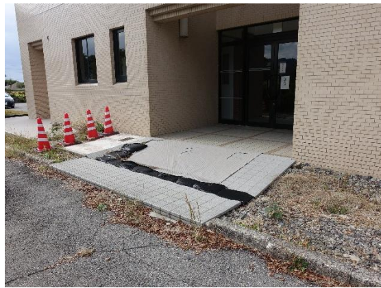
図 4.33.15 外構部の地盤変状
