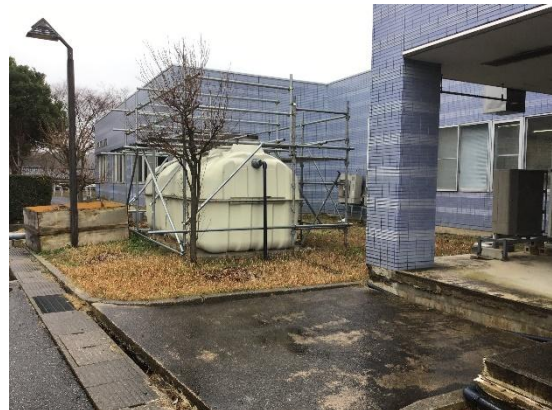
(d) 仮設の浄化槽
