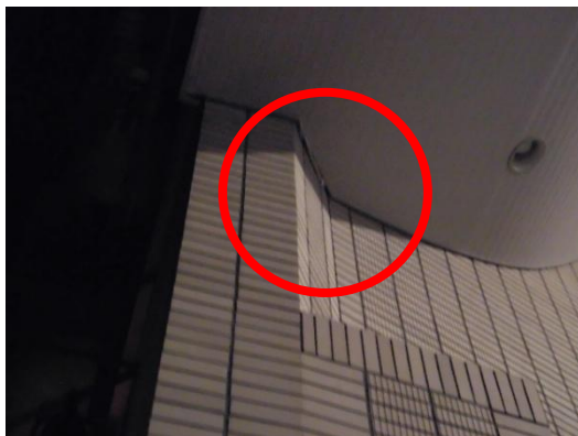
(a) ホール天井損傷箇所
