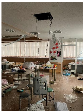
図 4. 26. 6 照明器具の落下
