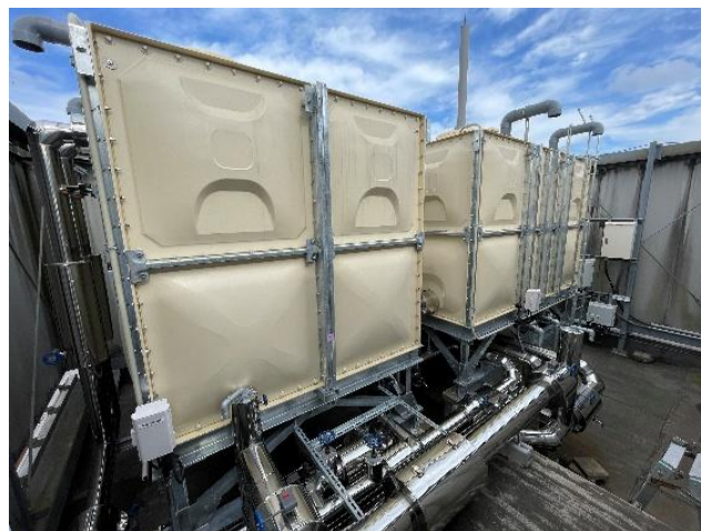
図 4.21.9 地震後に更新したタンク
