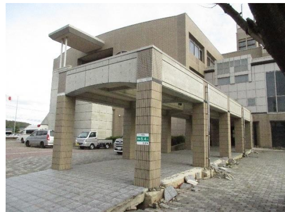
図 4.28.8 建築物 AB 北西側の地盤変状
