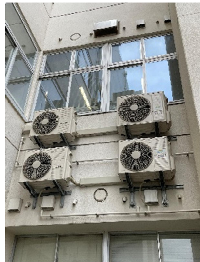
(d) エアコン室外機
