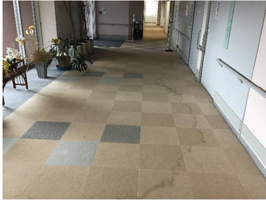
(a) 天井からの漏水跡
