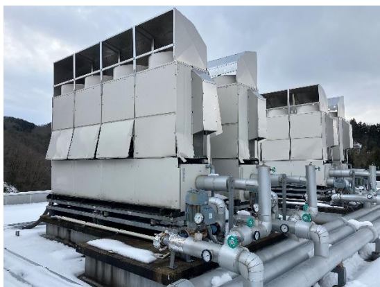
図 4. 26. 8 空冷ヒートポンプチラー外板剥がれ
