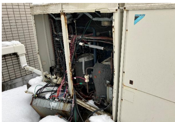
図 4. 26. 11 パッケージエアコン室外機部品落下
