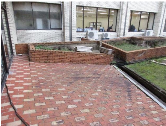
図 4.29.7 建築物 AC 北側の地盤変状
