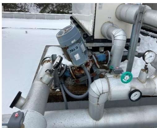
図 4. 26. 10 ポンプ架台転倒
