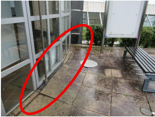
図 4.4.2 入口付近地盤沈下（建築物 D）
