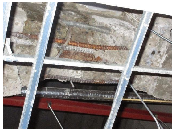
図 4.32.6 屋上階梁の損傷
