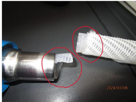
(b) 生産用水の配管破断
