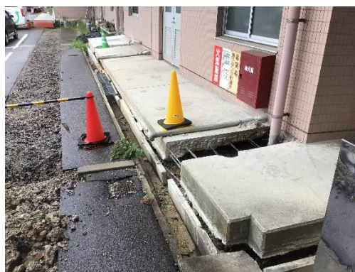
(b) 建築物周辺地盤のずれ
