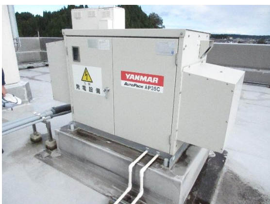
図 4.30.5 自家発電設備（建築物 AD-1）
