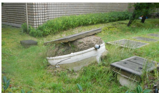
(b) 損傷箇所
