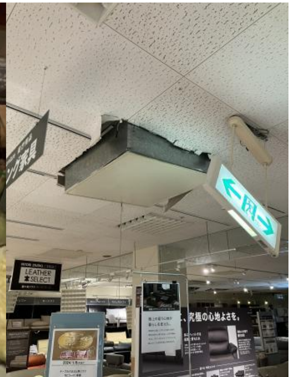
図 4.11.5 排煙口パネルの脱落
