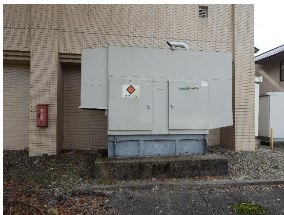
図 4.33.6 自家発電設備
