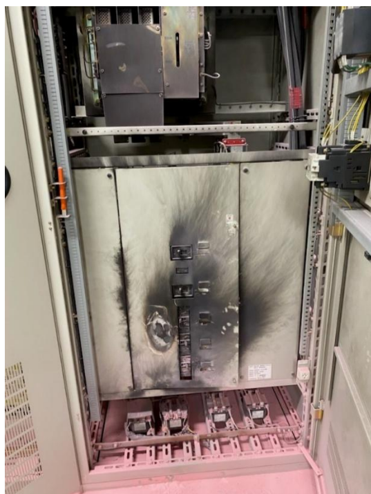
(a) 盤内部配電盤
