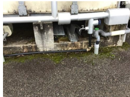
(b) 仮設市水引込接続部
