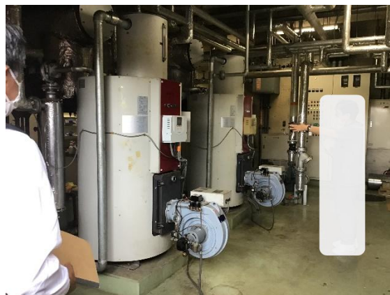
(b) 停止したボイラ
