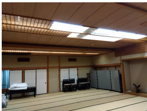
図 4.18.2 大広間の天井材の脱落
