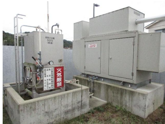
図 4.33.12 自家発電設備
