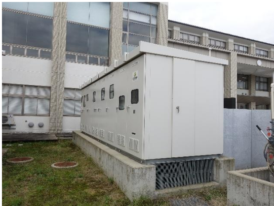
図 4.33.11 屋外キュービクル
