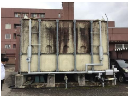
(a) 屋外設置の受水タンク
