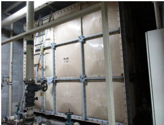
図 4. 29. 5 受水タンク（繊維強化プラスチック製）
