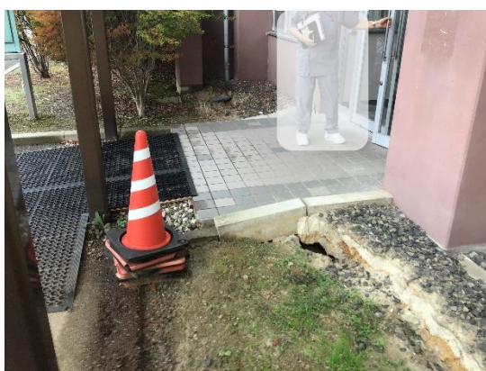
(a) 建築物周囲の地盤沈下状況
