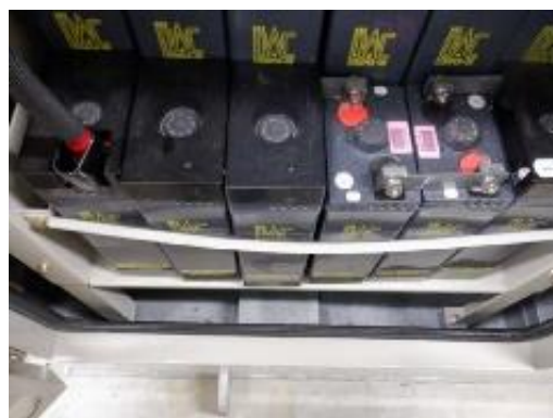
(b) バッテリー損傷
