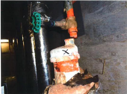
(a) エア抜き配管損傷箇所
