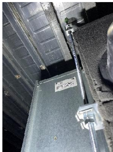
(c) 機器吊り支持状況 1
