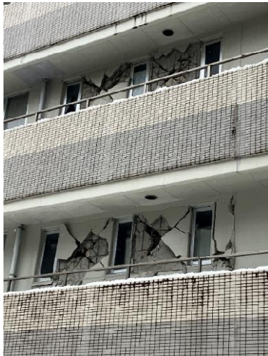
図 4. 26. 2 方立壁のせん断破壊
