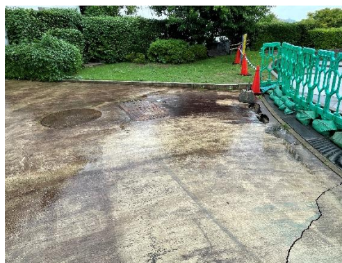
(b) 地中埋設物の沈下状況
