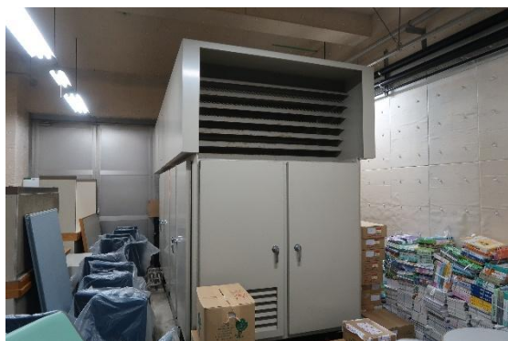
図 4.28.3 自家発電設備
