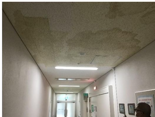
(a) 天井からの漏水跡
