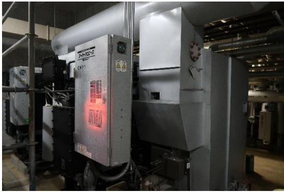
図 4.30.9 ボイラ（建築物 AD-1）
