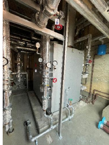
(b) 蒸気ボイラ（損傷無し）
