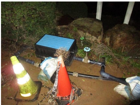
図 4.32.11 給水元からの仮設配管
