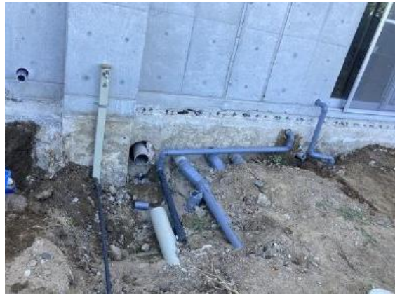
図 4.12.3 排水管の破断・復旧の状況
