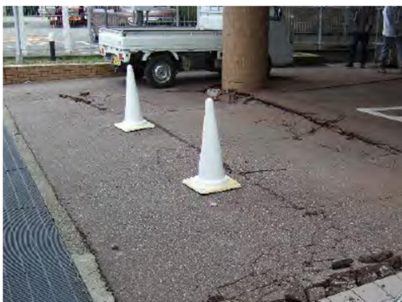
図 4.8.2 建築物周囲の地盤沈下の状況
