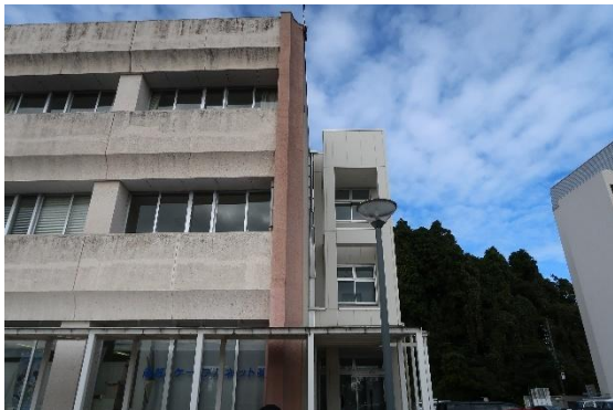
図 4. 30. 13 増設エレベータのエキスパ ンションジョイントの損傷（建築物 AD-2）
