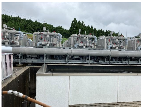
図 4.7.6 ろ過装置（復旧後）
