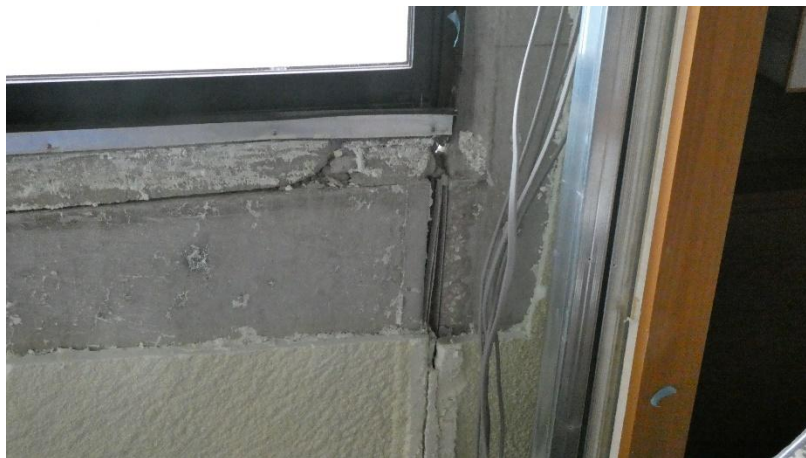
図 4.9.2 外壁のひび割れ（建築物内より撮影）
