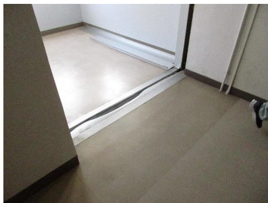
図 4. 30. 14 増設エレベータのエキスパ ンションジョイントの損傷（建築物 AD-2）
