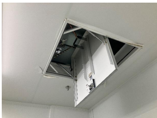
(a) 地震により開放した排煙口
