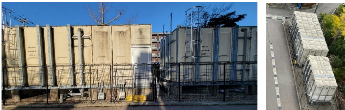
15 図 4.21.2 地震直後の本館・3病棟用の受水タンク（施設管理者より提供）
