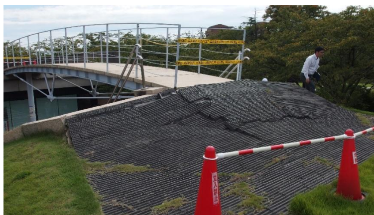
図 4.1.2 2 階出入口導線の被害（建築物 A）
