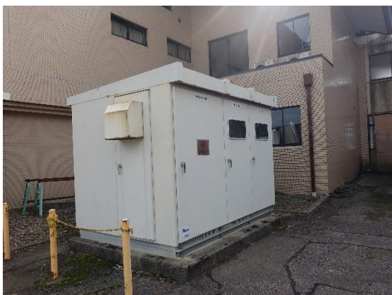
図 4.33.5 屋外キュービクル
