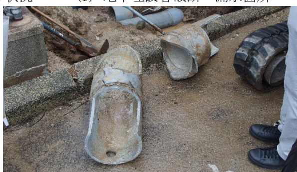
(h) 地中埋設管破断状況
