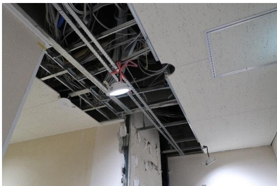
図 4.32.7 1 階天井の脱落
