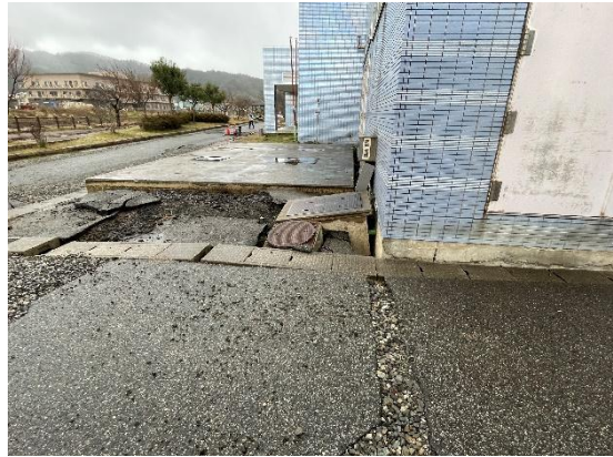
(b) 建築物周囲の地盤沈下、オイルタンク
