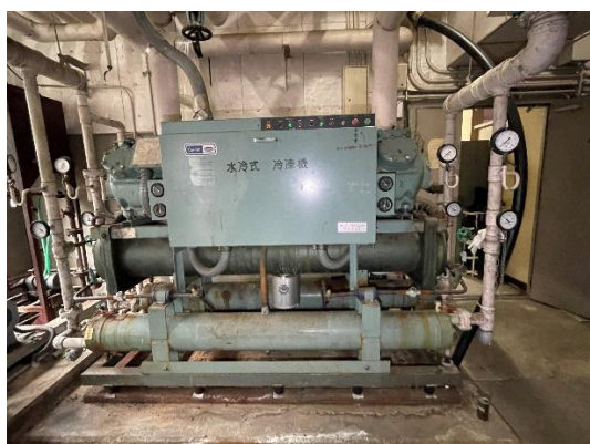
図 4. 18. 8 機械室の冷凍機（建築物 R）
