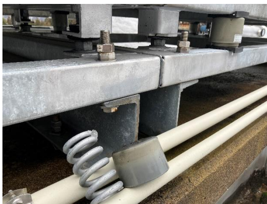
図 4. 26. 9 防振スプリング脱落
