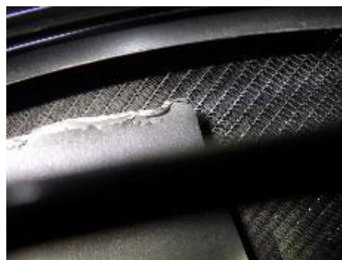
(d) 冷却ファン損傷
