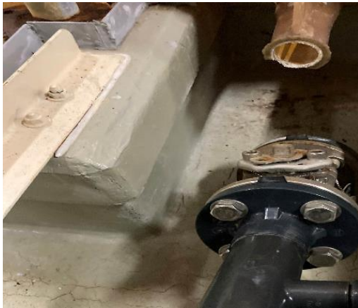
(a) 生産用水タンクの配管の破断
