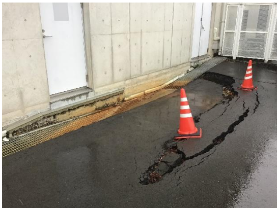
(a) 建築物外周の沈下
