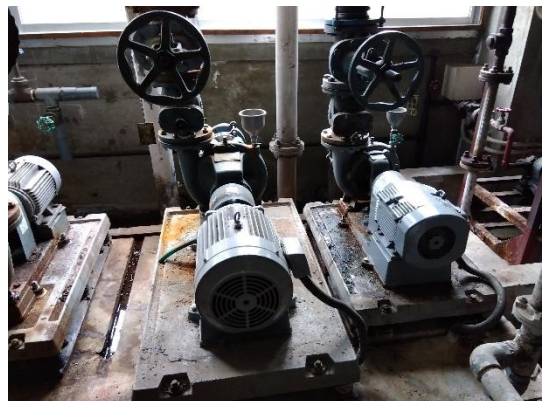
図 4. 18. 9 機械室のポンプ（建築物 R）
