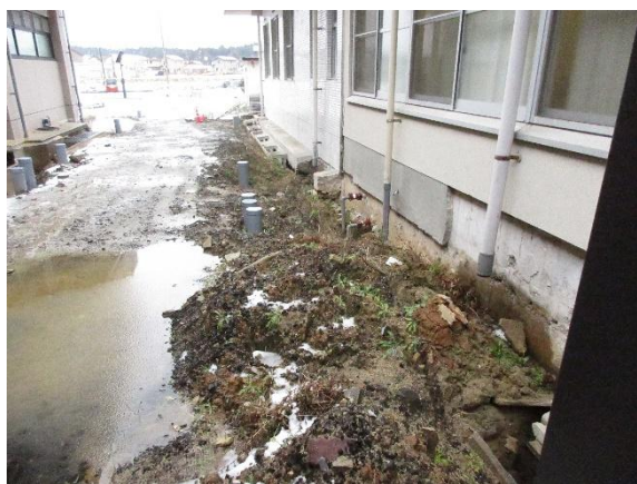
(c) 建築物周辺地盤の沈下
