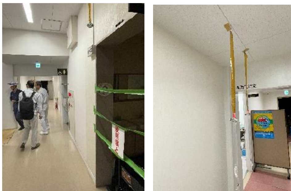
(a) 使用禁止になった1階のトイレ
